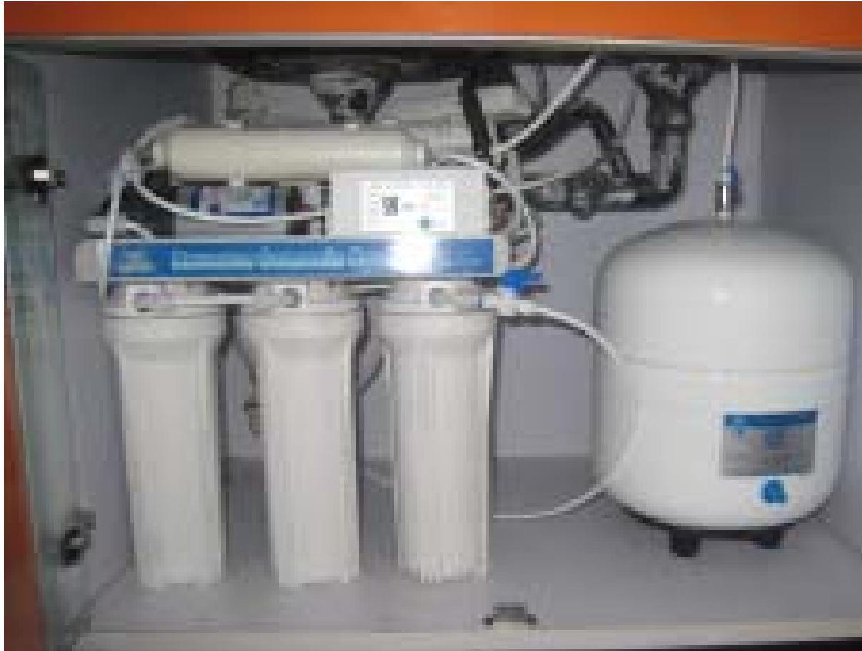
Figura 2 Purificatore acqua installata sotto al lavadino della cucina
