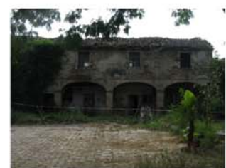
Sia l'edificio colonico che la stalla, che probabilmente verrà dismessa, non versano in buone condizioni architettoniche. Per questo se ne prevede il recupero attraverso la disposizione di un'altra delle corti giardino.
