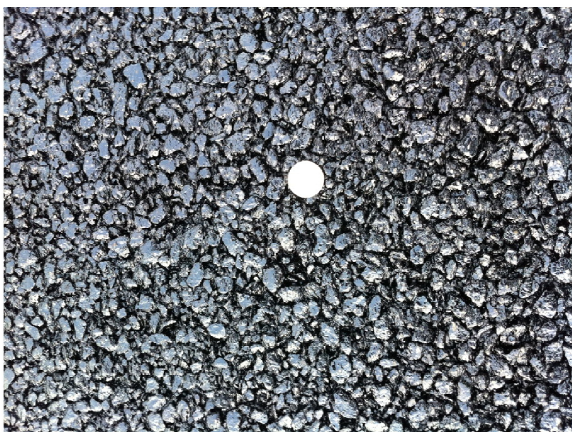
Figura 35 - analisi visiva dell'apertura dello strato d'usura open grade
