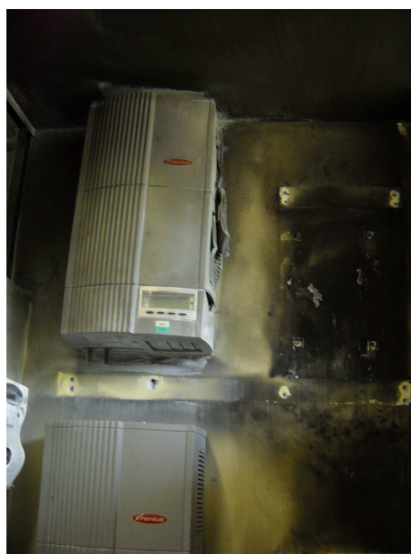
Figura 5.5 – Incendio degli inverter di un impianto fotovoltaico
