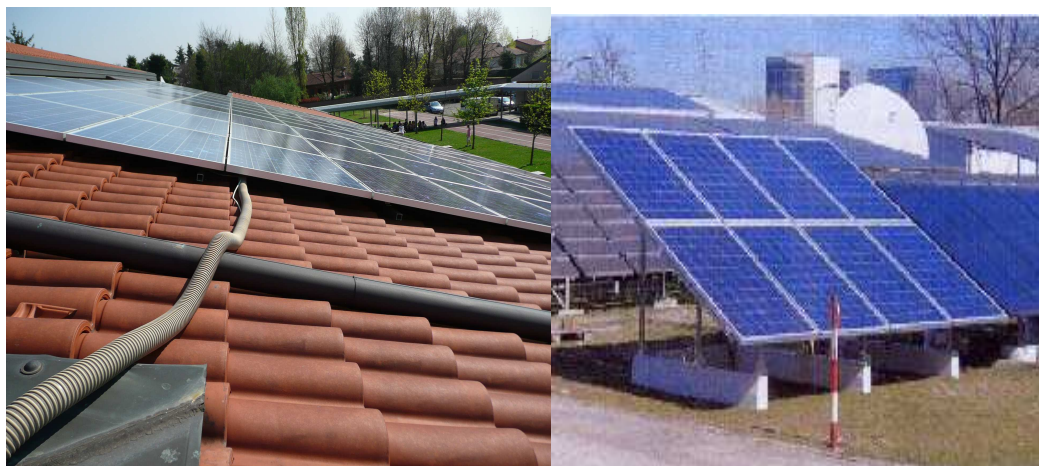
Figura 4.22 – Foto degli impianti P01 e Gfv13
