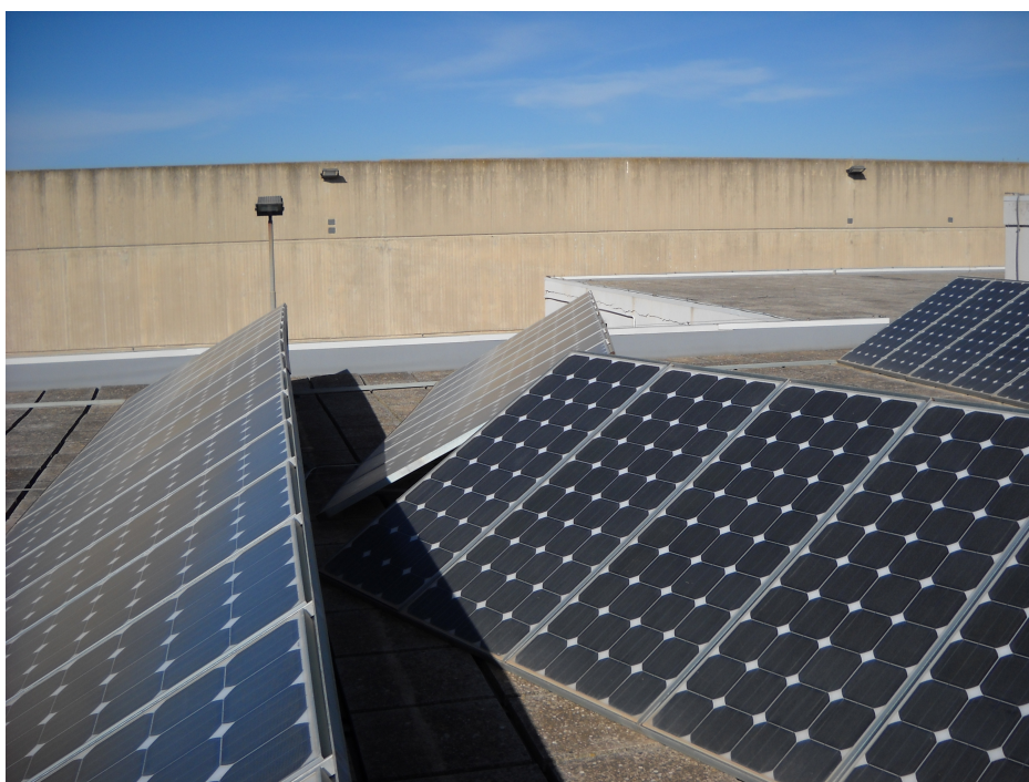
Figura 5.3 – Disallineamento delle schiere di moduli a causa dell'azione del vento
