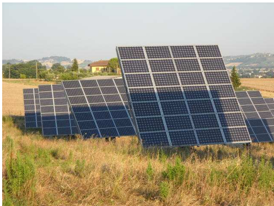
Figura 4.17– Impianto ad inseguimento installato nel Centro Italia.
