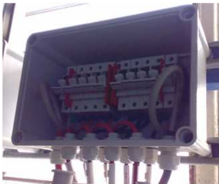
Figura 5.2 - Quadro di parallelo stringhe di 1° livello
