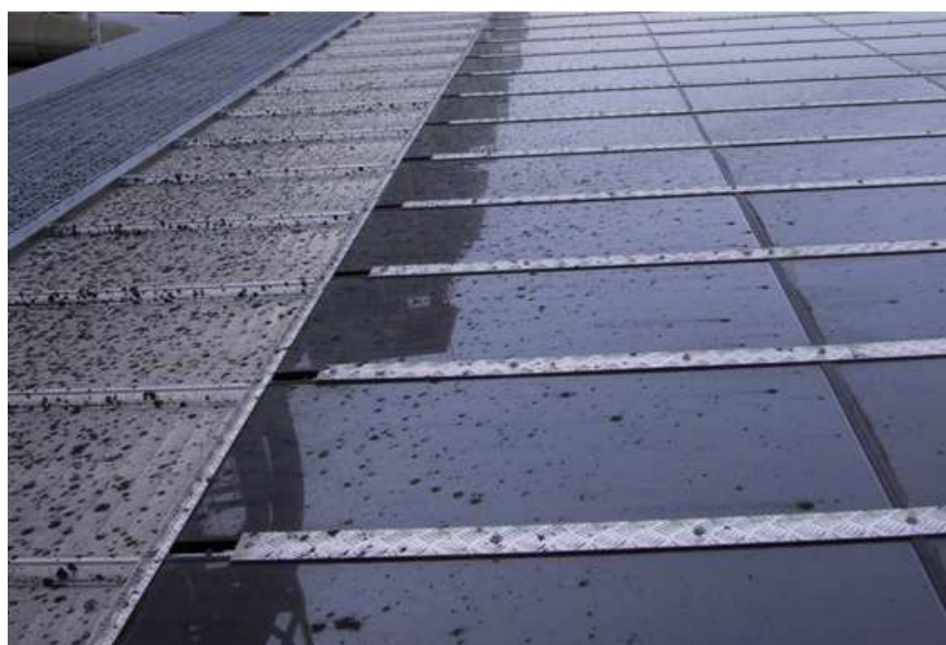
Figura 5.1 – Sporco dei moduli dovuto a depositi di carbone
