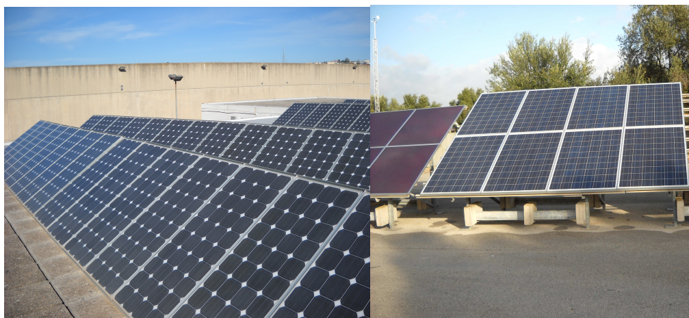
Figura 4.24 – Foto degli impianti P06 installato ad Ispica e sperimentale posizionato su una struttura a terra Gfv3
