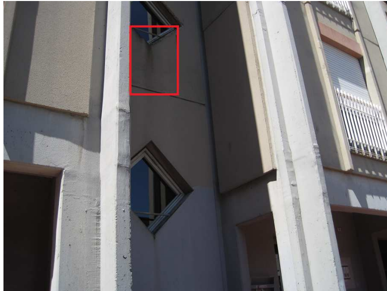
Immagine 3.3 Dilavamento differenziale finestre vano scale
