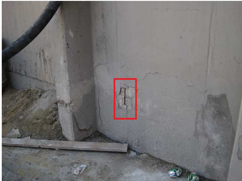
Immagine 3.5 Corrosione ferri solaio piano terra
