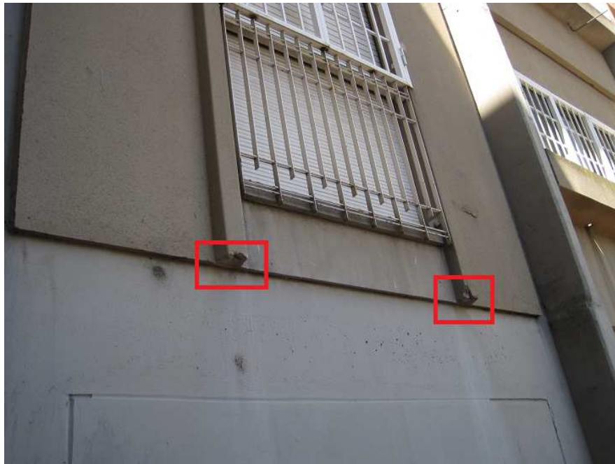
Immagine 3.13 Distacco cls in corrispondenza delle cornici delle finestre
