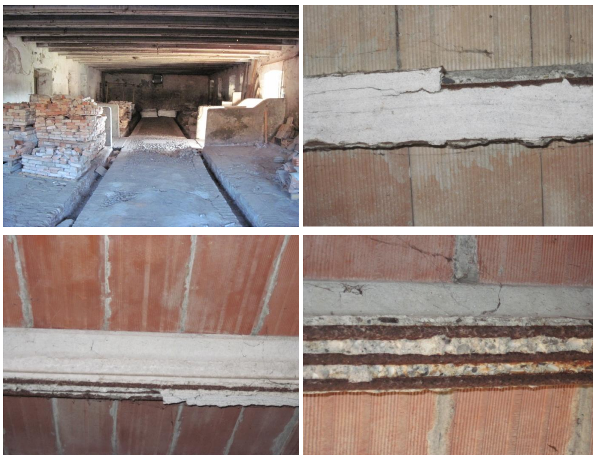
Fig. I Esempi di corrosione nelle travi all'interno di un edificio
