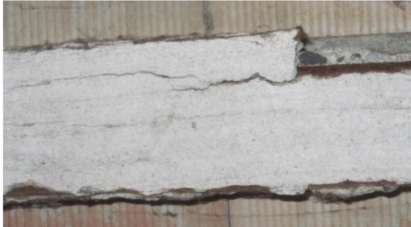
Fig.2.20 Fessurazione longitudinale e distacco del copriferro in una trave soggetta a corrosione
