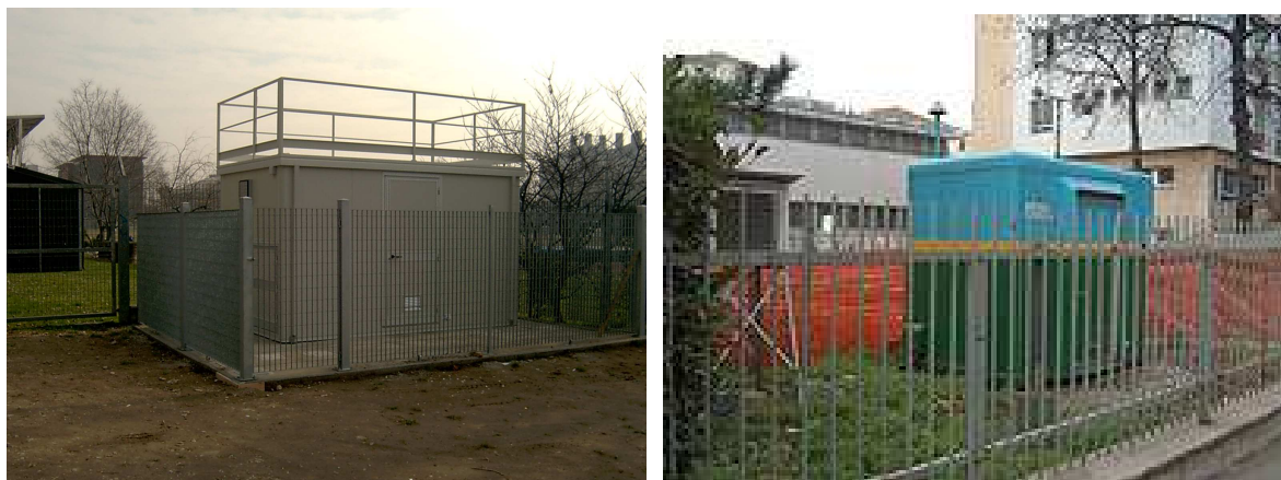
Figura 29 – Centralina di via Pascal (sinistra) e centralina di Viale Marche (destra).
