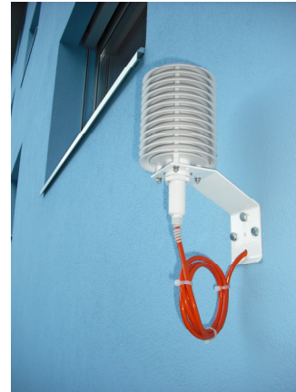
Figura 73 - Sensore di temperatura esterna posto sulla facciata NW
