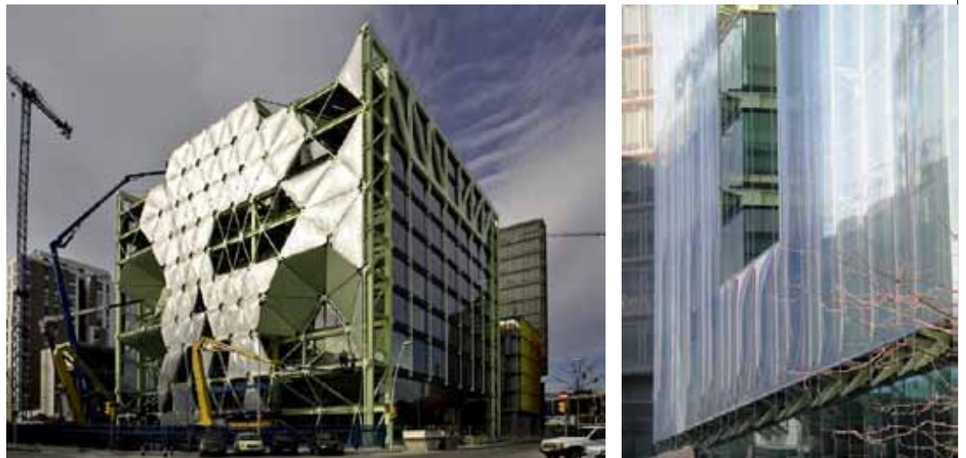
Figura 45: Edificio con applicazione di pannelli di Efte
