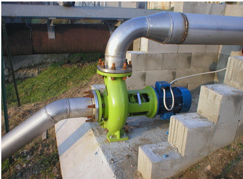
FOTO 13: PAT installata presso l'impianto di Mortara
