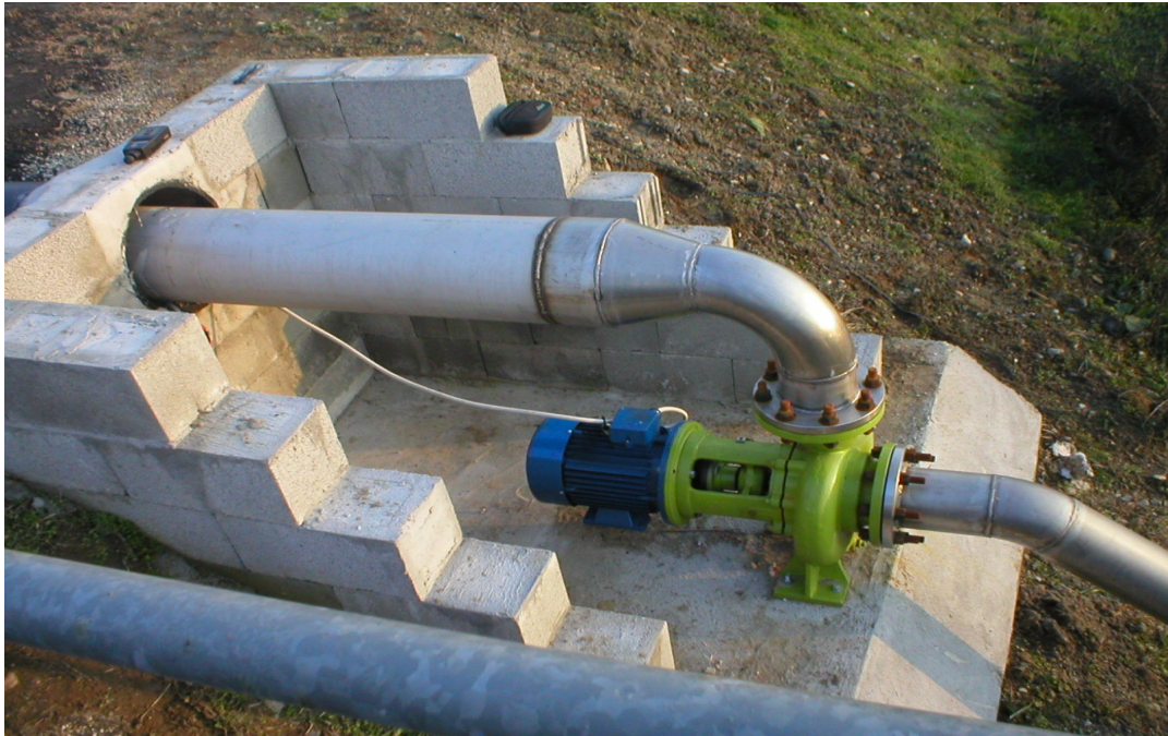
FOTO 12: PAT installata presso l'impianto di Mortara
