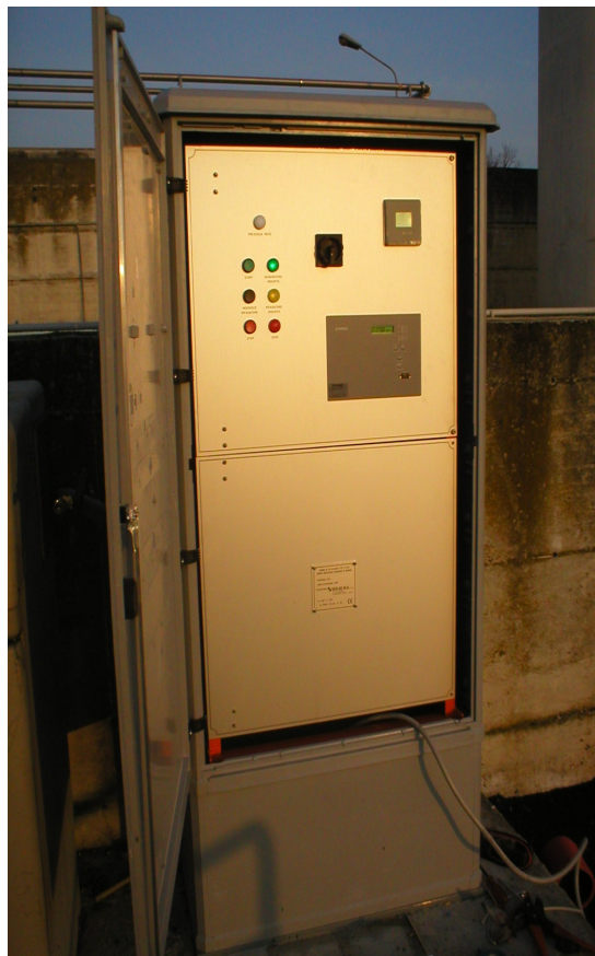
FOTO 15: Quadro elettrico della PAT installata presso l'impianto di Mortara
