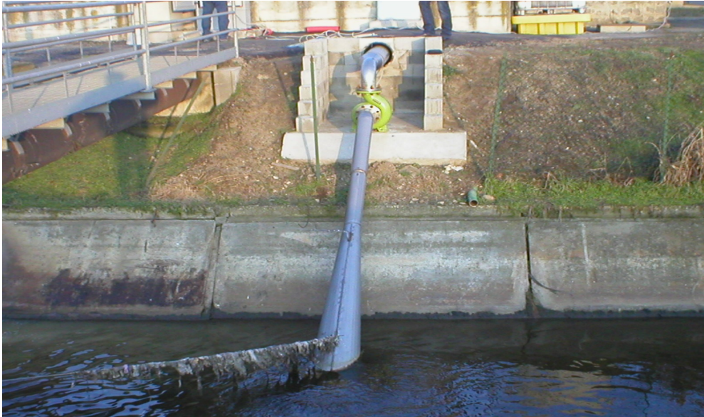
FOTO 14: PAT installata presso l'impianto di Mortara
