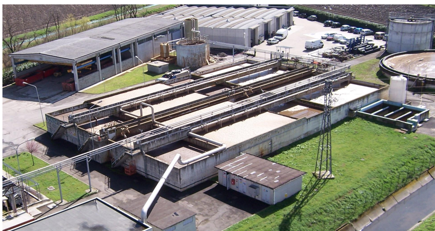
FOTO 4: Comparti linea A per ossidazione biologica/nitrificazione
