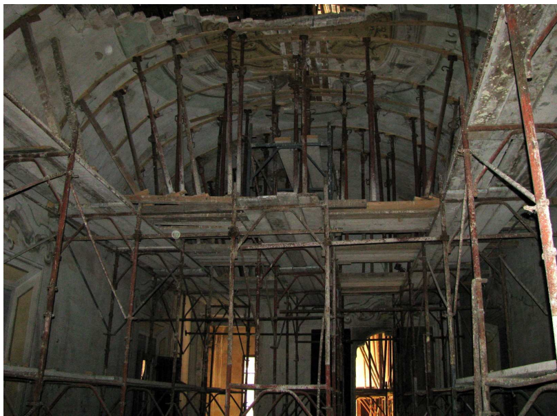
Figura 4.10: veduta della camera delle Congregazioni dopo il crollo di parte della volta. (marzo 2010)
