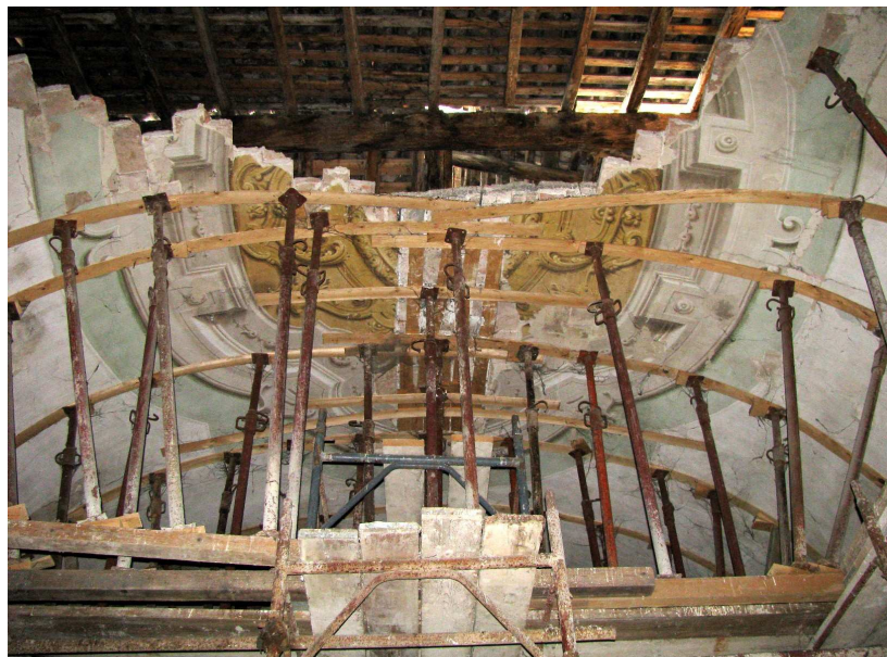
Figura 4.11: particolare della volta a padiglione parzialmente crollata durante il sisma del 1996. (marzo 2010)
