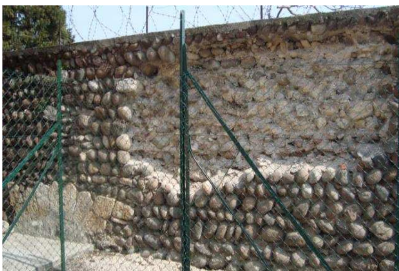
Fig. 150 Particolare delle mura magistrali in stato di degrado.
