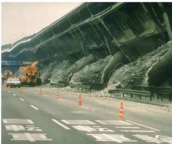
Figura 5 Effetti del terremoto
