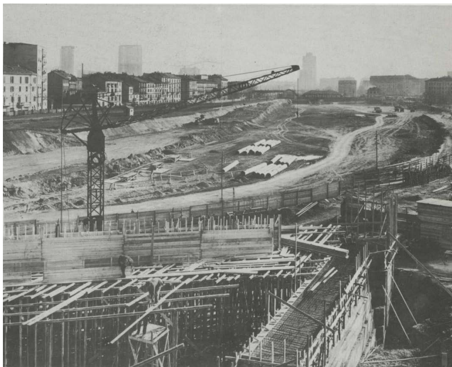
Fig.27 Lavori di sterro per la costruzione della nuova stazione delle linee Varesine e cavalcavia di via Farini (1950)
