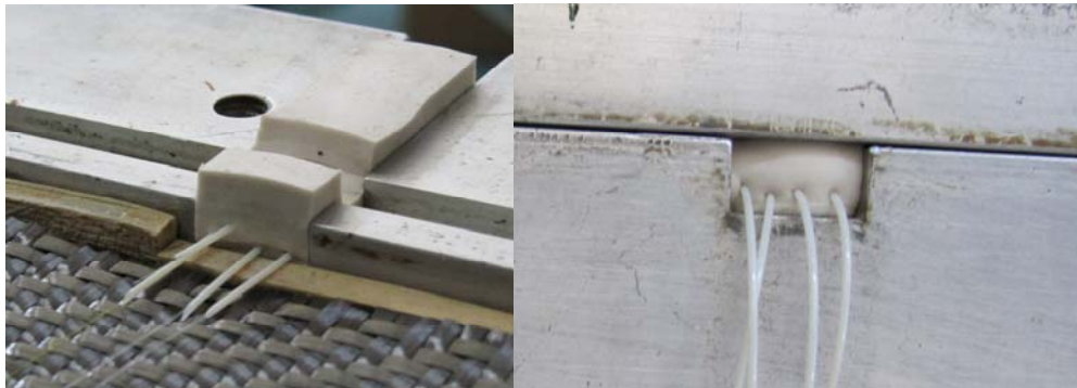
Figura 3.4 Vista interna ed esterna del sistema di ingresso delle fibre ottiche
