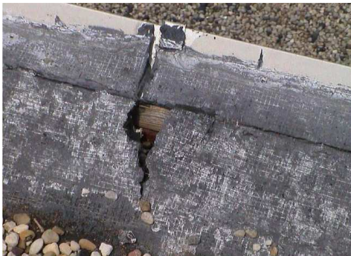
Figura 11: [CP 12] lesione per fessurazione del supporto
