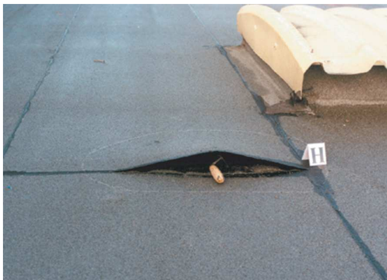
Figura 9: [CP 06] distacco per difetti di saldatura
