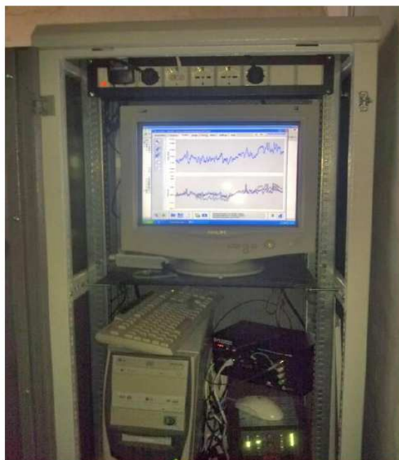
Figura 2 : Armadio con la strumentazione[18];
