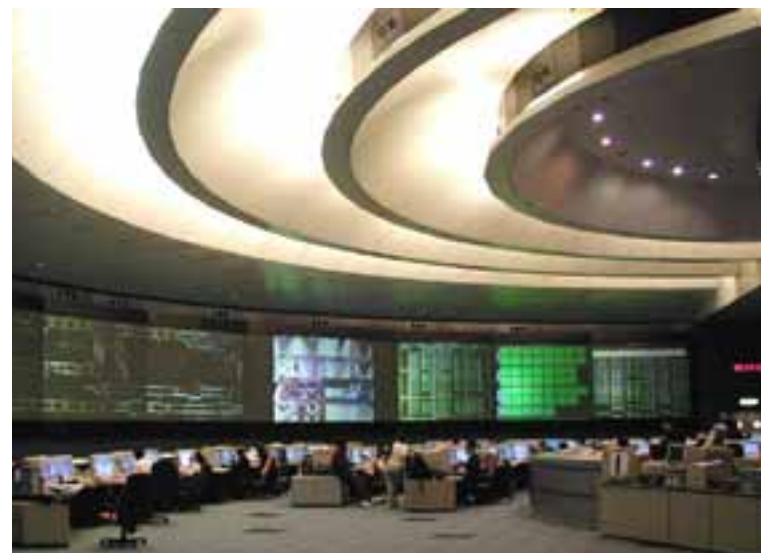
10.2 centro di controllo
