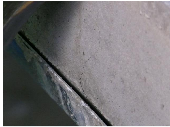
Figura 5.5.4 Distacco laterale della lamiera dal calcestruzzo
