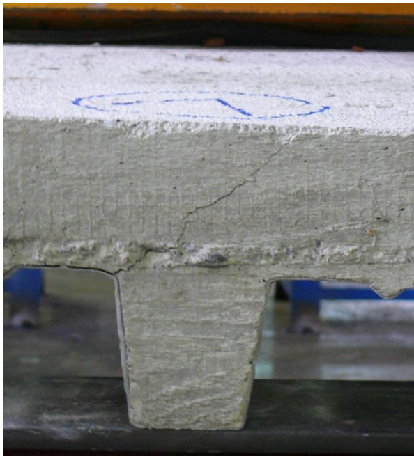
Figura 5.5.5 Fessura in caso di non planarità della soletta
