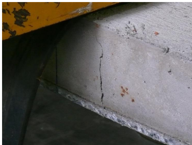
Figura 5.5.1 Fessura verticale per rottura a flessione
