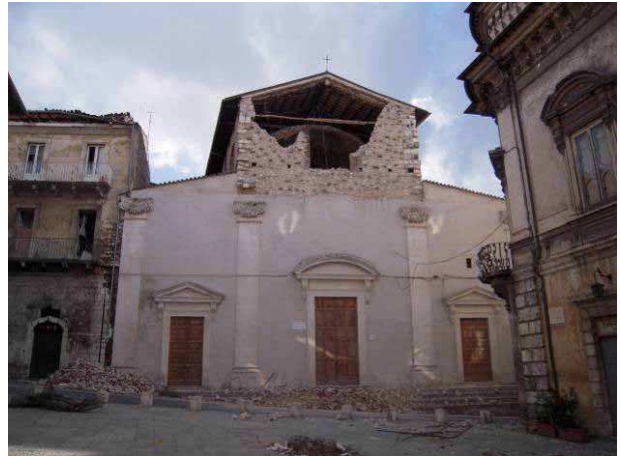
Figura 4.30 - Collasso della porzione sommitale della facciata nella chiesa di san Biagio.
