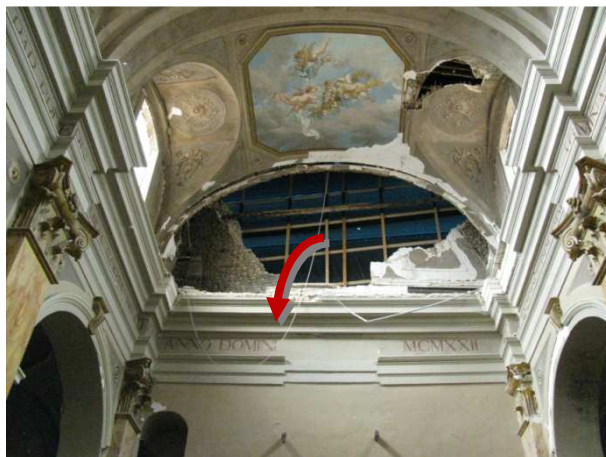
Figura 2.25 - Collasso della porzione superiore della facciata e della parete a una testa interna.
