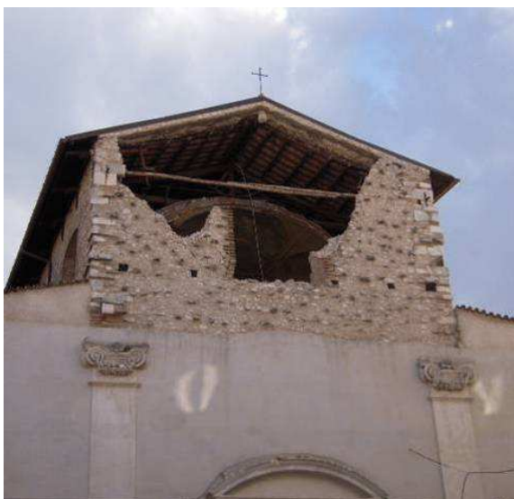
Figura 6.6 – Collasso della sommità della facciata della chiesa; visibile il tirante in legno.
