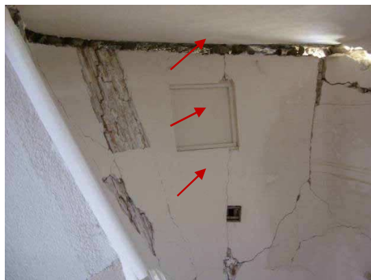
Figura 4.26 – Lesioni sull'imposta della volta principale dovute al distacco della facciata.
