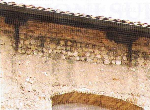
Figura 4.20 - Esempio di "radicamento" all'Aquila: paletto ligneo di ancoraggio delle capriate della chiesa di S. Maria del Carmine.
