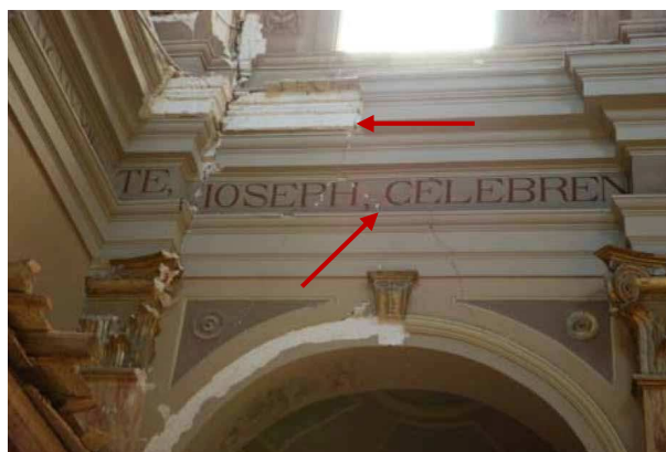
Figura 6.5 – Fessurazione nella prima arcata di sinistra della parete della navata principale.
