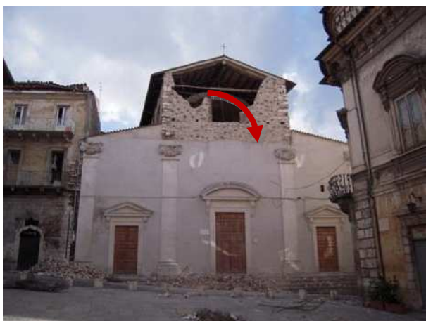
Figura 2.24 - Collasso della porzione superiore della facciata
