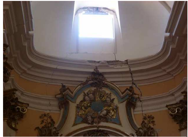
Figura 2.54 - Lesioni nella parete di fondo dell'abside
