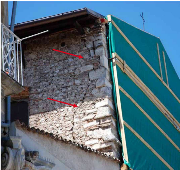
Figura 4.31 – Fessure nella parete longitudinale in prossimità del margine sinistro del timpano.
