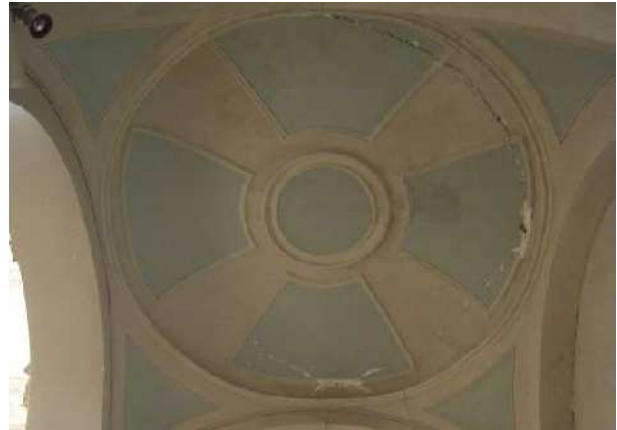
Figura 2.27 – Lesioni nelle cupolette della navata laterale sinistra
