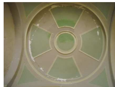
Figura 4.54 - Fessurazione circolare nelle volte delle navate laterali.
