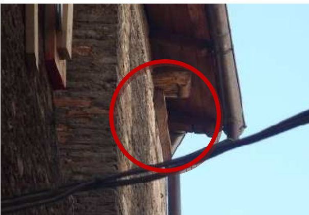
Figura 2.47 - Capriata con paletto ligneo visto da via Roio
