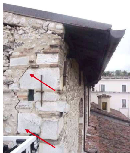
Figura 6.4 – Fessura al margine destro del timpano.
