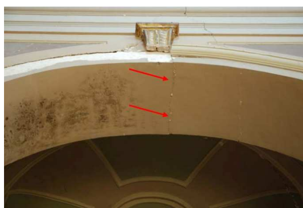
Figura 4.47 – Scorrimento trasversale della prima arcata sul lato sinistro.
