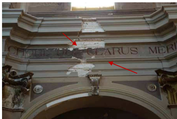
Figura 4.46 – Fessurazione della quarta arcata di sinistra della parete della navata principale.
