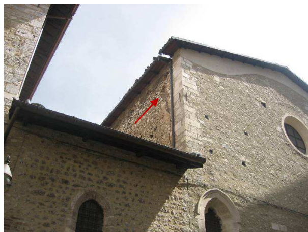
Figura 6.22 – Innesco di ribaltamento della facciata.
