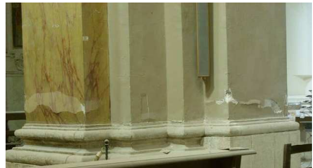
Figura 2.28 – Lesioni sub-orizzontali alla base dei pilastri fra navata centrale e navata laterale destra.
