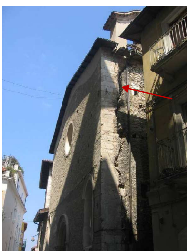
Figura 6.23 – Innesco di ribaltamento della facciata.
