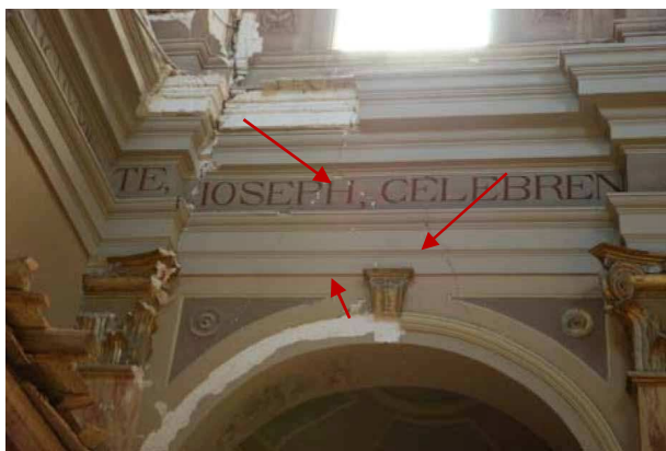
Figura 4.45 – Fessurazione della prima arcata di sinistra della parete della navata principale.
