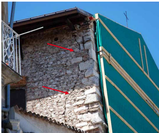
Figura 6.3 – Fessura nella parete longitudinale in prossimità del margine sinistro del timpano.
