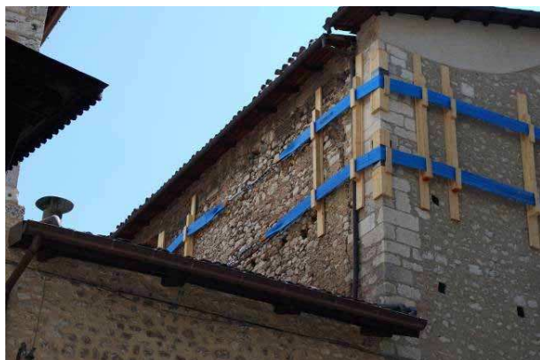
Figura 4.25 – Fessurazione lungo il collegamento tra la facciata e il muro longitudinale di sinistra.
