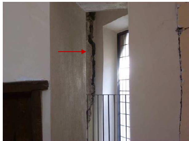
Figura 6.20 – Lesioni associabili all'innesco del meccanismo di ribaltamento della facciata lungo l'angolo di sud-est.
