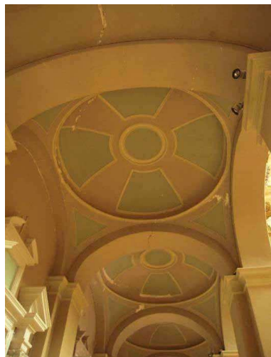
Figura 4.53 – Lesioni nelle cupolette della navata laterale di sinistra, viste verso la facciata.
