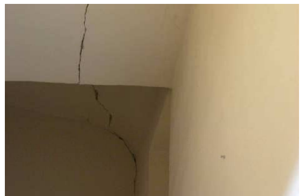
Figura 2.55 – Lesioni nelle strutture orizzontali degli ambienti d'angolo, angolo di nord est.
