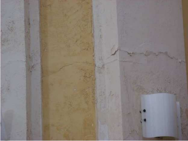
Figura 2.56 - Lesioni sub-orizzontali a sinistra dell'abside
