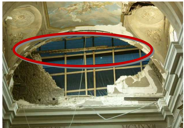
Figura 2.21 - Catena lignea presente in facciata e messa in luce mediante il crollo della facciata stessa vista dall'interno della chiesa.
