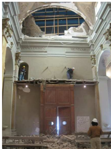
Figura 4.34 – Interno della chiesa di san Biagio dopo il crollo della parte sommitale della facciata.
