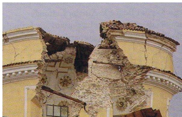
Figura 4.19 - Esempio di "radicamento" all'Aquila: cerchiature lignee a diversi livelli nella cupola della chiesa di S. Maria del Suffragio.
