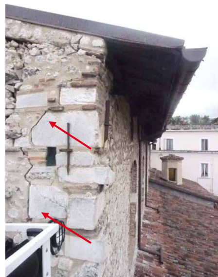
Figura 4.32 – Fessura al margine destro del timpano.
