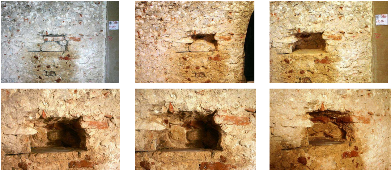
Figura 6.51 - Smontaggio parziale della muratura in corrispondenza del taglio superiore della prova SB-J1D.
