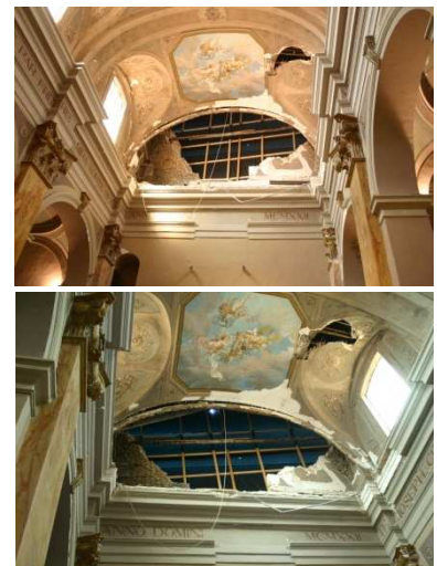
Figure 4.35/4.36 – Collasso interno della sommità della facciata.
