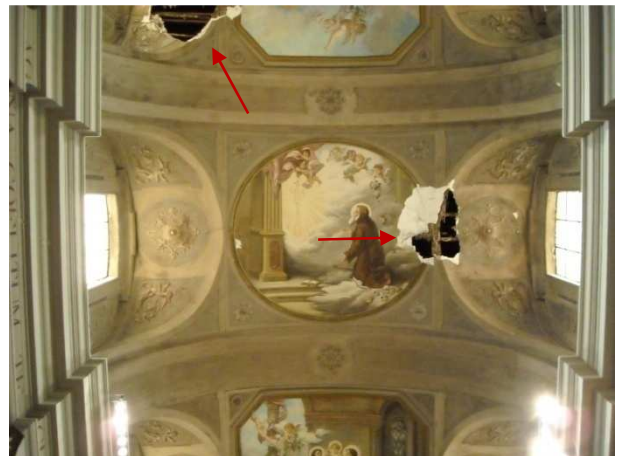
Figura 6.13 – Crolli localizzati nella volta della navata centrale.
