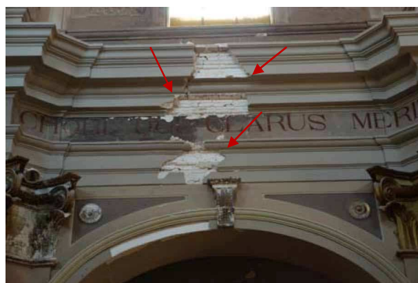
Figura 6.7 – Fessurazione nella quarta arcata di sinistra della parete della navata principale.
