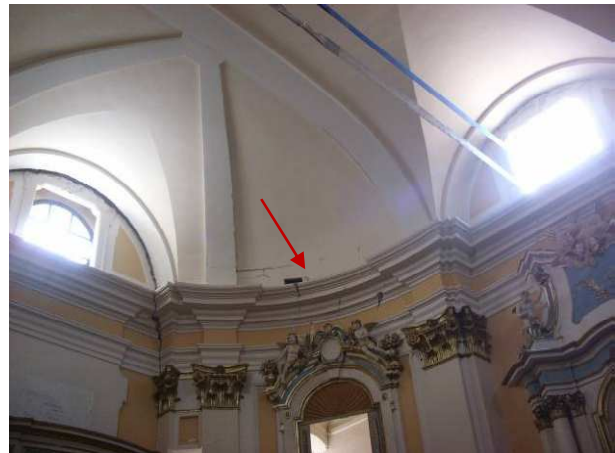
Figura 6.29 – Fessurazione delle murature laterali sinistre.
