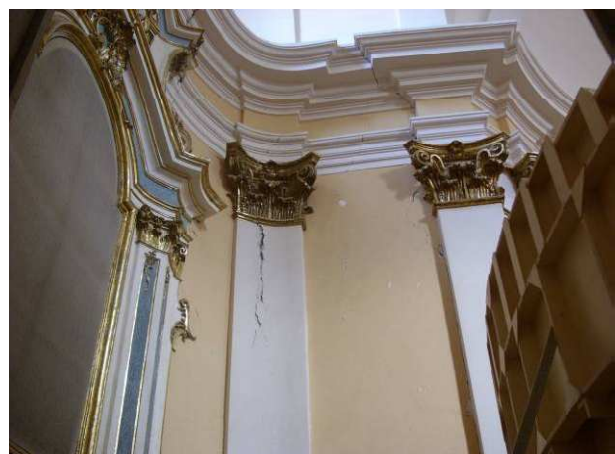
Figura 6.32 – Lesioni nella parete di destra dell'abside.
