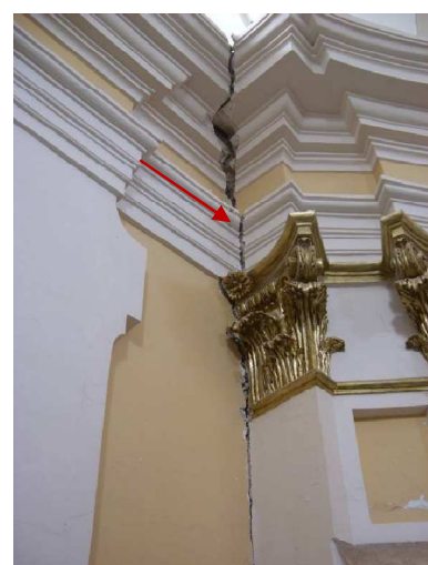
Figura 6.25 – Lesioni interne legate al ribaltamento della facciata.
