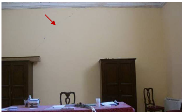
Figura 2.30 – Sacrestia: lesione inclinata sulla muratura confinante con palazzo Piscitelli.
