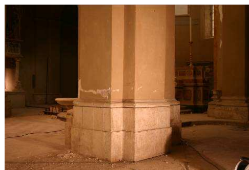
Figura 4.41 – Fessurazioni alla base dei pilastri.
