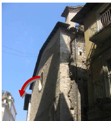
Figura 2.50 – Innesco del meccanismo di ribaltamento di facciata.
