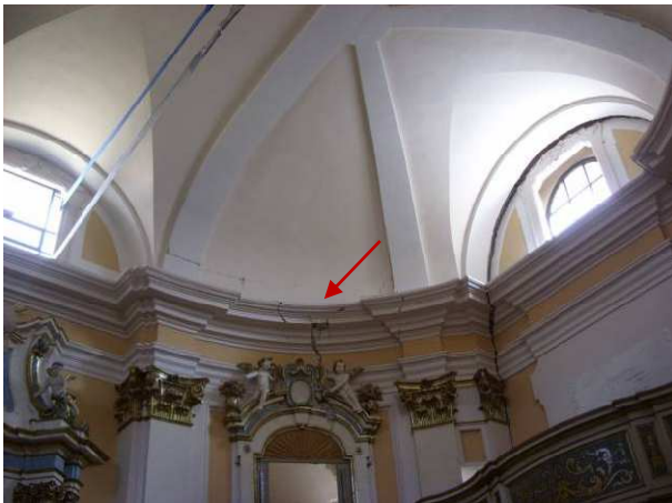
Figura 6.28 – Fessurazione delle murature laterali destre.
