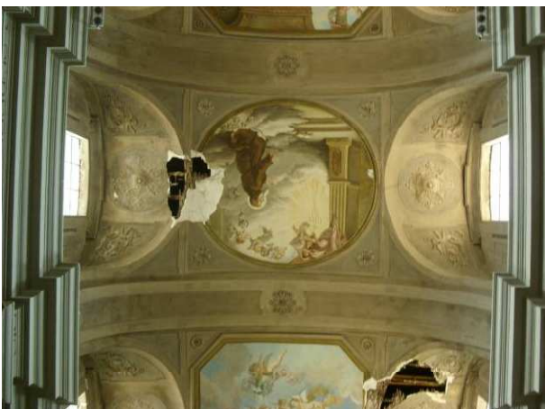
Figura 2.26 - Crolli della volta in camorcanna sulla navata centrale.
