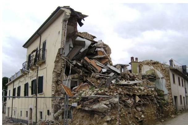
Figura 3.2 – Edifici crollati nel centro storico di Onna.
