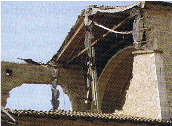
Figura 4.21 - La moderna copertura latero-cementizia della chiesa di S. Maria Paganica: capriate in travetti prefabbricati tipo "Varese"
