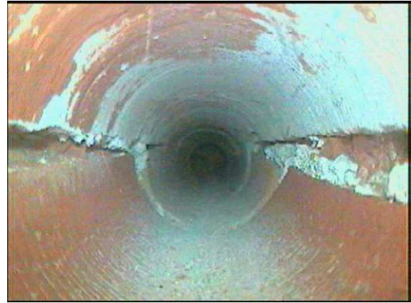
Figura 6.180 – Vista interna OSG-E6.
