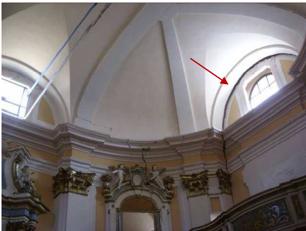
Figura 6.19 – Lesioni associabili all'innesco del meccanismo di ribaltamento della facciata lungo il alto
