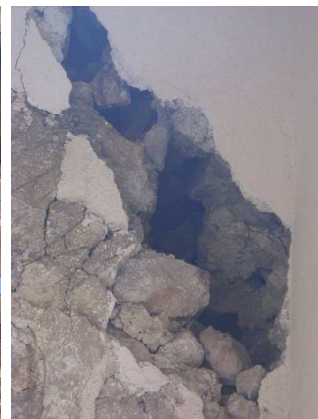
Figura 2.43 - Ammorsamento in angolo fra via Roio e via degli Scardassieri, vista interna.
