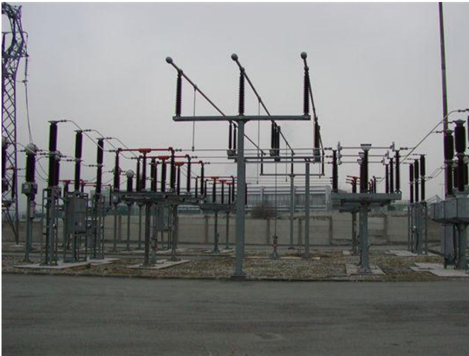
Figura 2.3 - Sbarra AT di una cabina primaria
