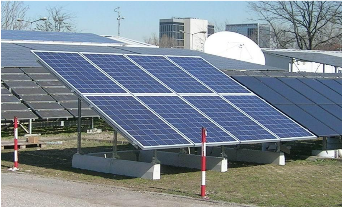
Figura 3.1 : Impianto Fotovoltaico ERSE
