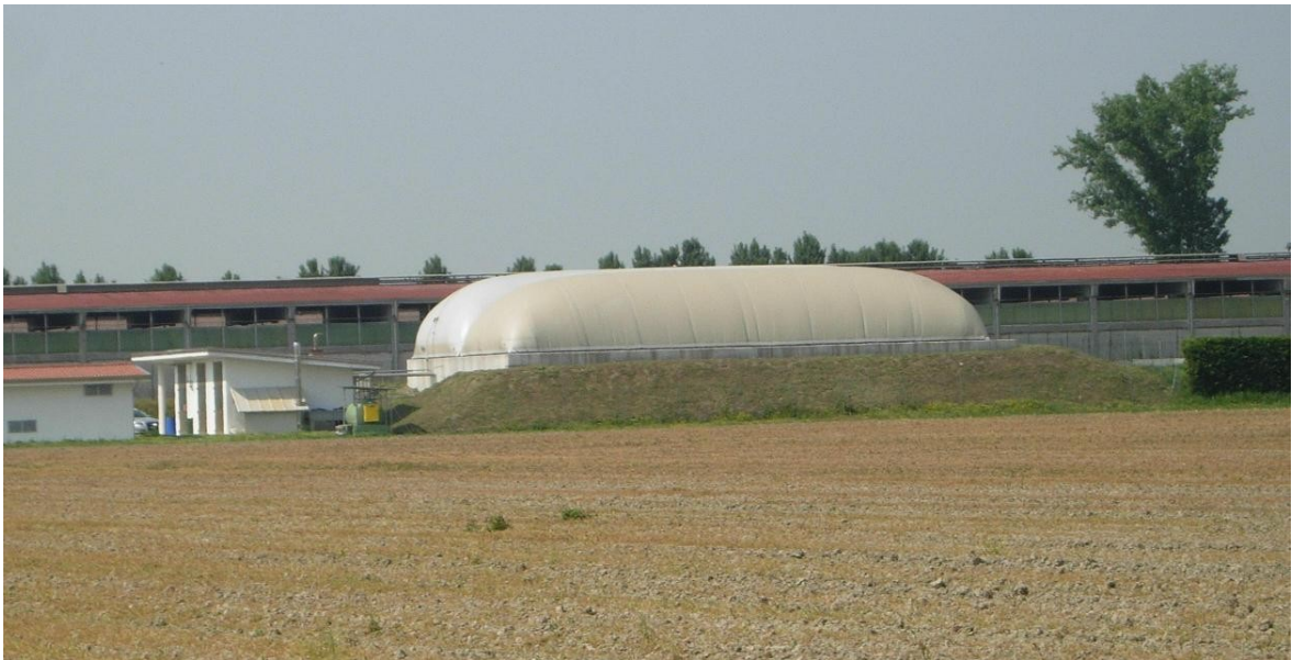
Figura 4.13 - Cupole gasometriche montate sulle vasche dei digestori
