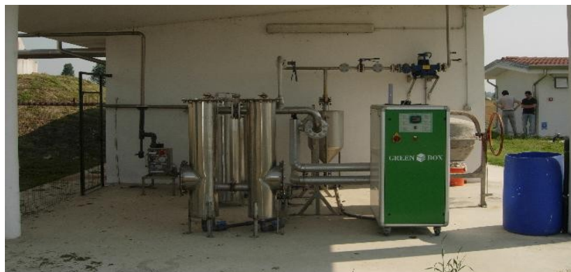
Figura 4.14 - Sezione di depurazione del biogas
