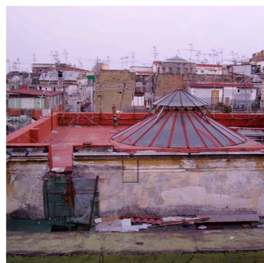
L'elevato stato di degrado dei Quartieri Spagnoli è visibile da molti punti di vista.
