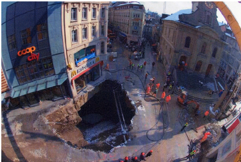
Figura 2.41: Esempio di formazione di camini e cedimenti superficiali indotti dal tunneling: Lusanne metro (documentazione archivio Pizzarotti).
