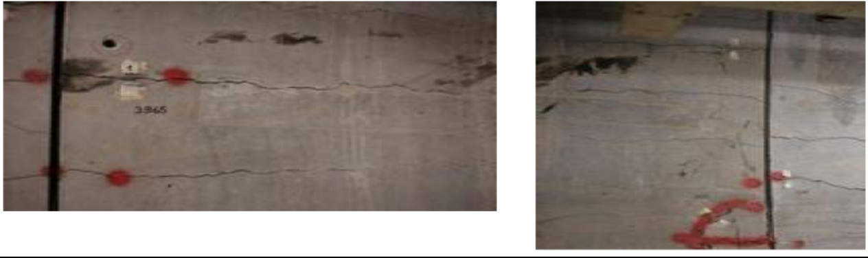
Figura 2.22: Rotture dei conchi di rivestimento, (Relazione Tecnica Pro Iter, 2010).
