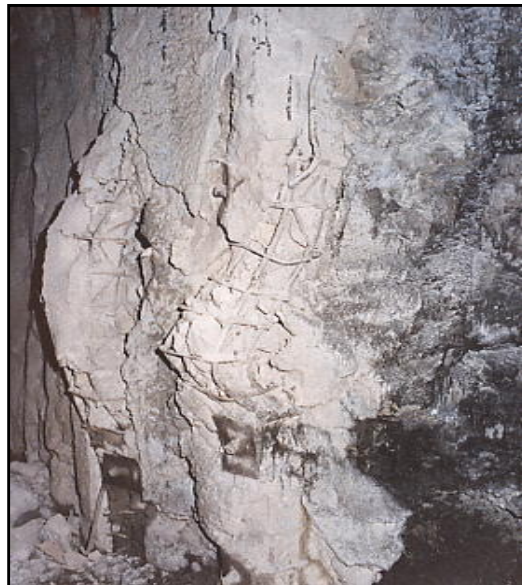
Figura 2.16: Esempio di instabilità del cavo nella galleria ferroviaria Fleres: in paragnaiss tettonizzati e argillificati, con coperture di 600 m e con rivestimento di prima fase, si verificano convergenze radiali fino a oltre 60 cm (10%) senza crolli, ma con completa plasticizzazione del priverivestimento che, anzi, viene lasciato libero di deformarsi. Le convergenze si protraggono nel tempo per diversi mesi anche a fronte fermo (creep) (Pizzarotti 2006).
