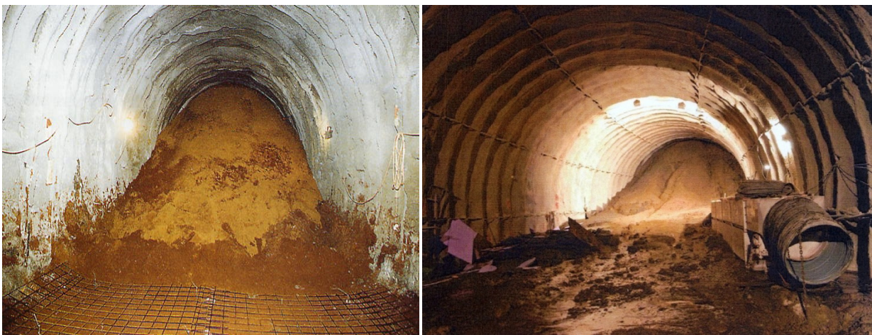
Figura 2.2: Esempi di instabilità del fronte di scavo (Pizzarotti 2006).
