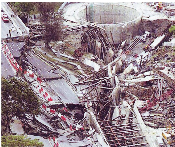
Figura 2.43: Esempio di formazione di camini e cedimenti superficiali indotti dal tunneling (documentazione archivio Pizzarotti).
