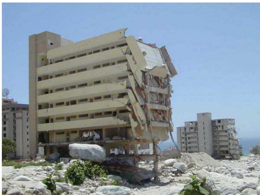
Figura 1.8 - Palazzo gravemente danneggiato dal passaggio di un debris flow a Quebrada San Julián, a nord di Caracas, Venezuela ( 14-16 dicembre 1999).
