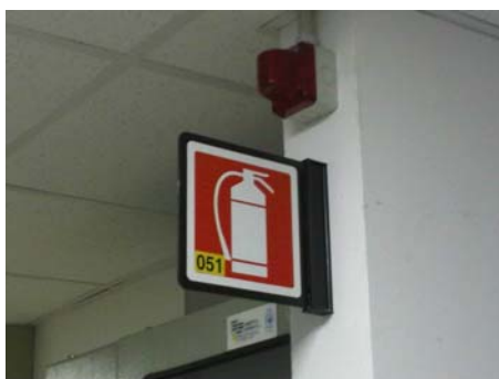
Figura 3-20 Segnaletica di sicurezza 1
