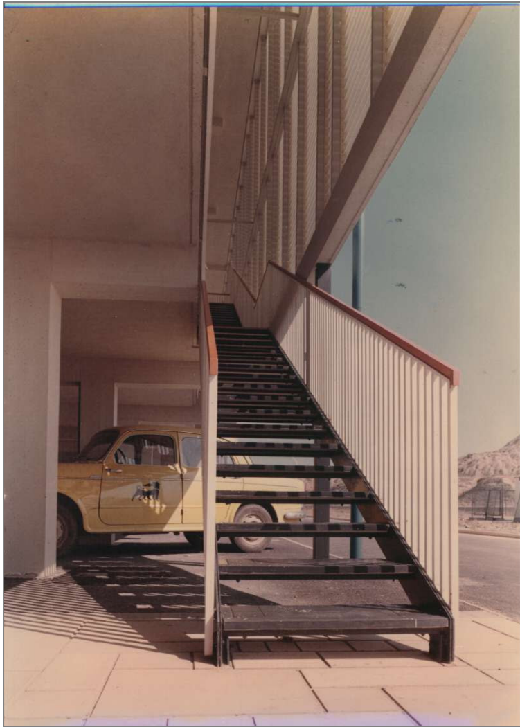
fig. 112 – una rampa di scale al piano terra (archivio studio alberti matti ferrari)
