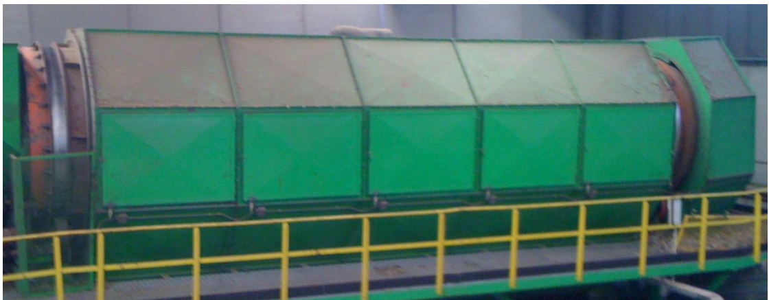
Figura 3.9 – Vaglio rotante dell’impianto di Siderno.
