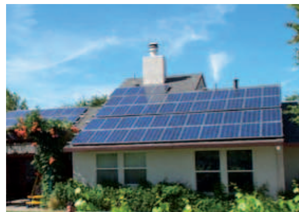
Lato sud-particolare del tetto con pannelli solari
