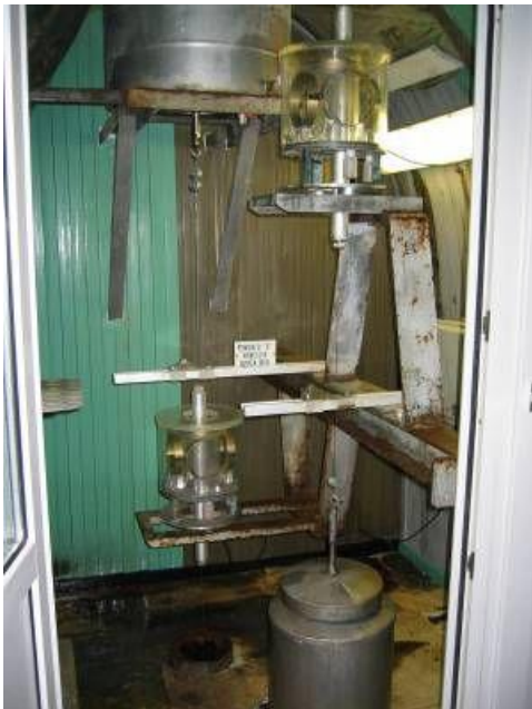
Figura 1. 7 Camera dei pendoli della diga di Beauregard (AO).
