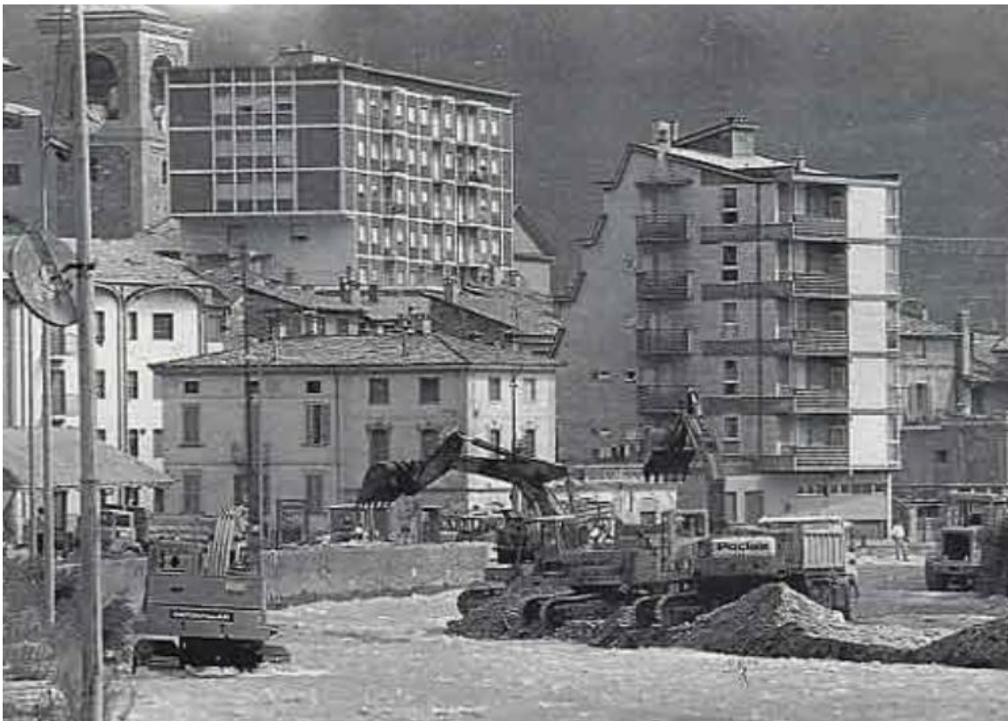
Figura 1.22 Ruspe impegnate ad eliminare detriti dal fiume Mallero dopo la piena.
