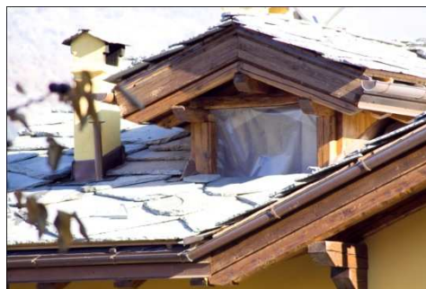
Figura 21 – Canali di gronda in rame –
