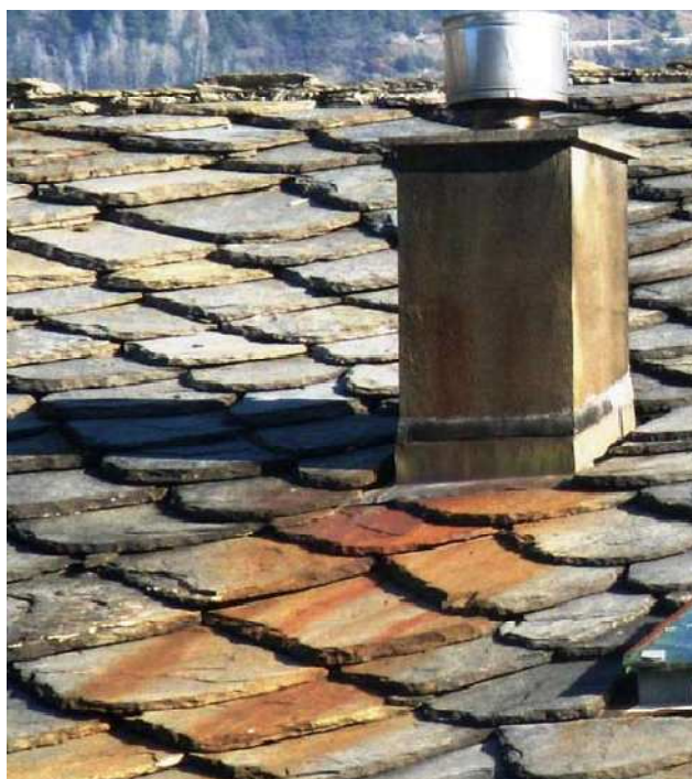
Figura 176 – Particolare della striscia di ruggine originata dalla scossalina del camino –
