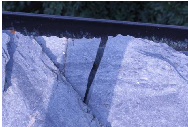
Figura 148 – Particolare di una losa fratturata e del canale di gronda parzialmente pulito –
