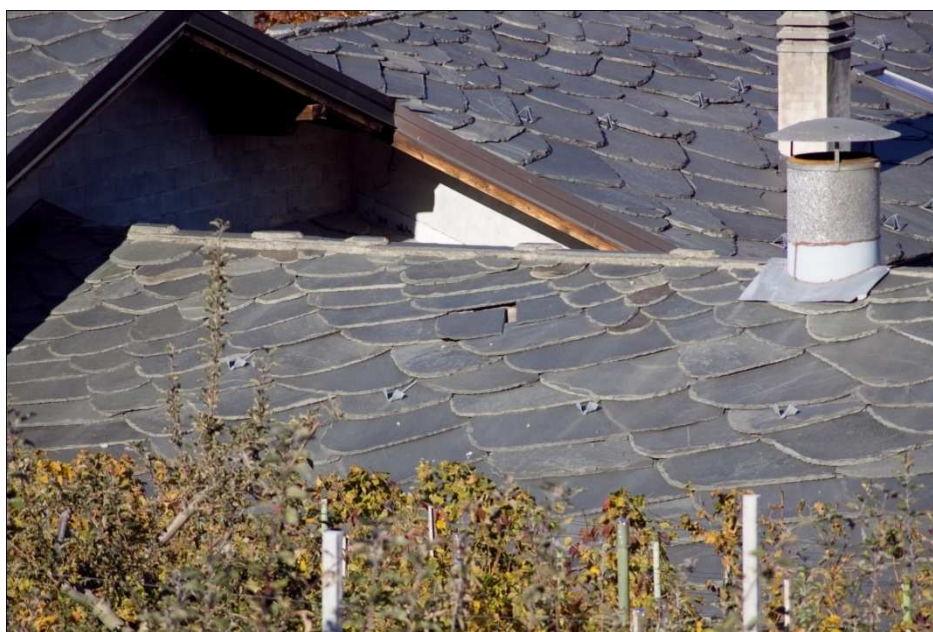
Figura 168 – Particolare di una losa fratturata sulla falda esposta a Sud –
