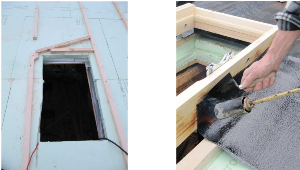
Figura 22 - Foro in cui verrà inserito il lucernaio e fase di impermeabilizzazione del lucernaio –
