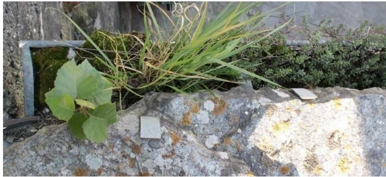
Figura 85 - Canale di gronda non soggetto a manutenzione -
