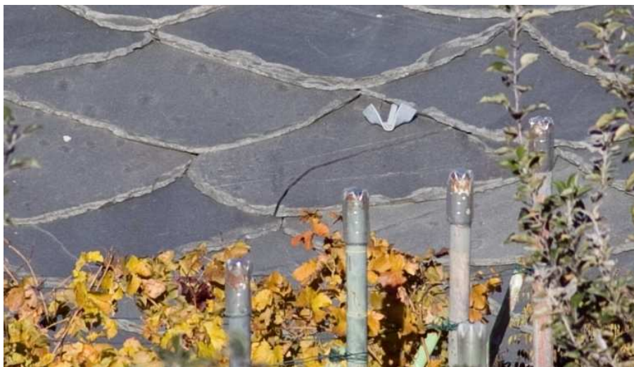
Figura 169 – Losa fratturata sulla falda esposta a Sud sotto il fermaneve –
