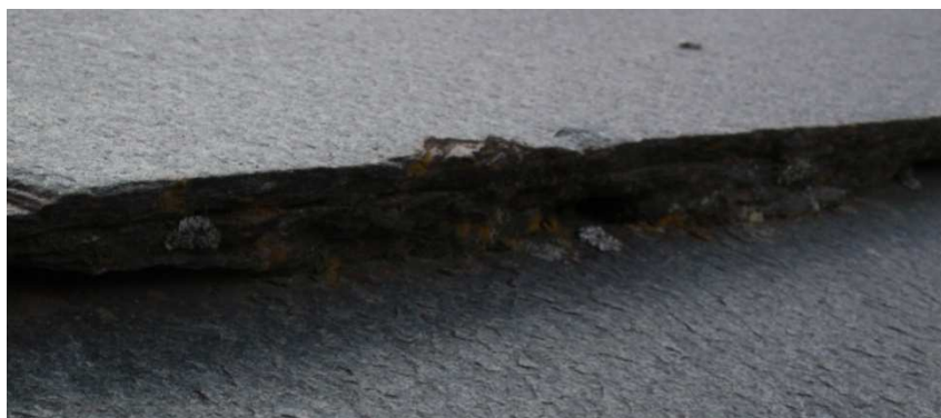
Figura 134 – Muschi e licheni sotto un bordo di una losa lavorata in maniera non corretta –
