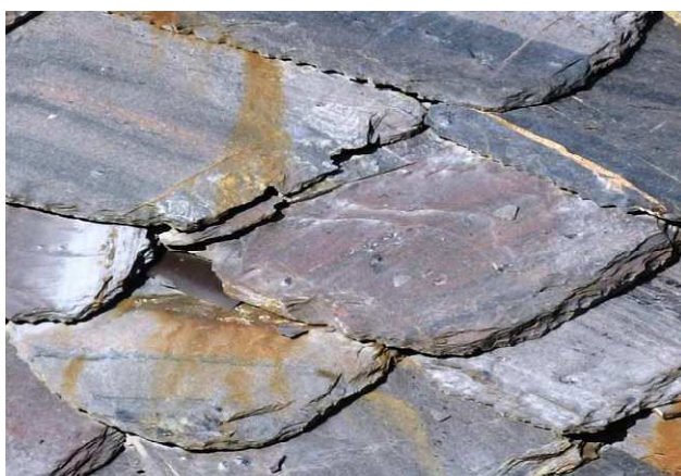
Figura 124 – Lose leggermente fessurate con piccoli distacchi di detriti –
