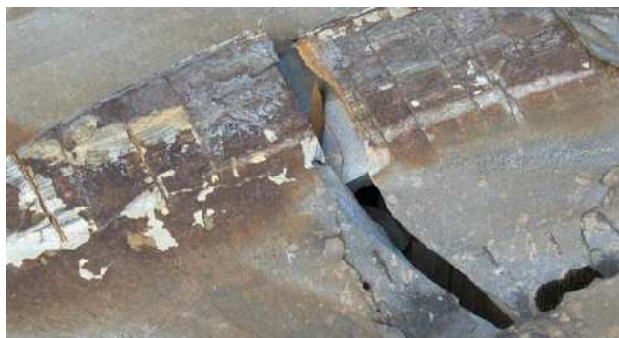
Figura 111 – Particolare di losa fratturata –
