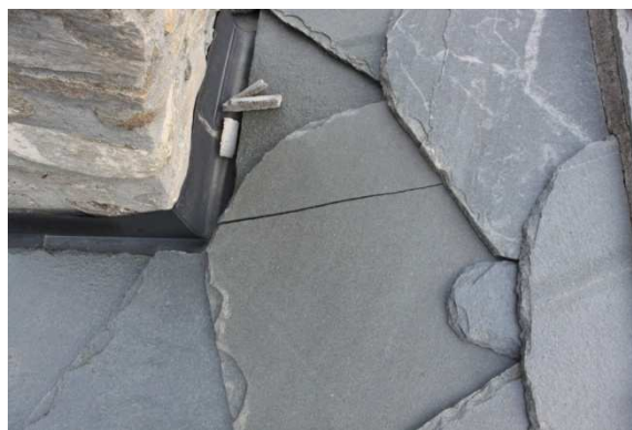
Figura 131 – Losa fratturata dietro un camino sulla falda Ovest e alcuni detriti –
