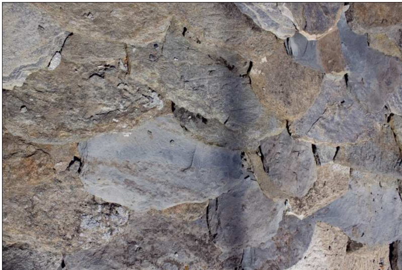
Figura 162 – Detriti presenti su gran parte della copertura –
