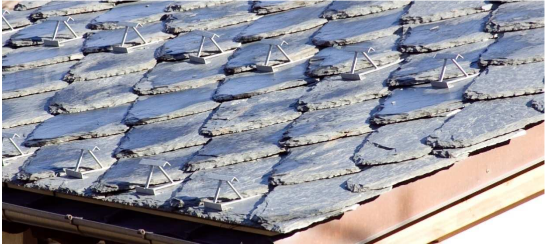
Figura 165 – Particolare della copertura in cui è visibile il ridotto spessore della losa e l'elevato numero di fermaneve installati –
