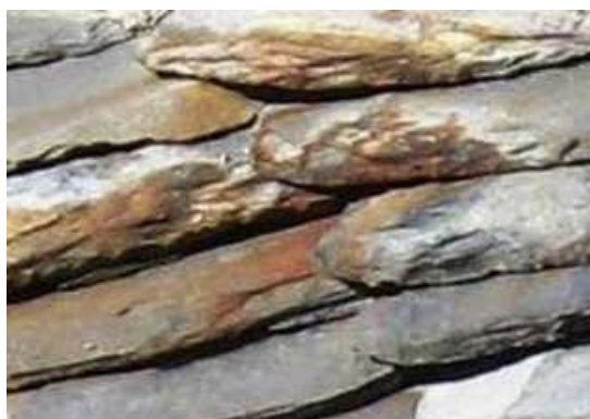
Figura 122 – Altra zone di origine della ruggine –
