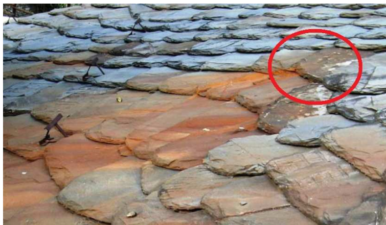
Figura 82 - Losa antiestetica che produce colata di ruggine sulla parte di manto sottostante –
