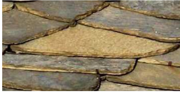
Figura 127 – Losa con colorazione tendente al giallo –
