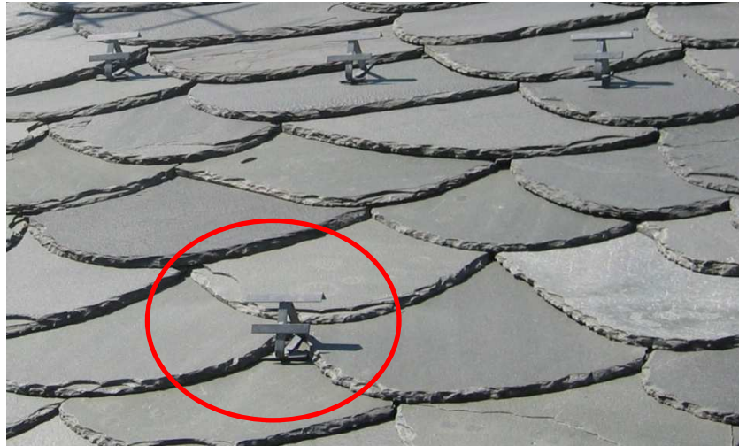
Figura 20 - Fermanee installati su copertura recente –
