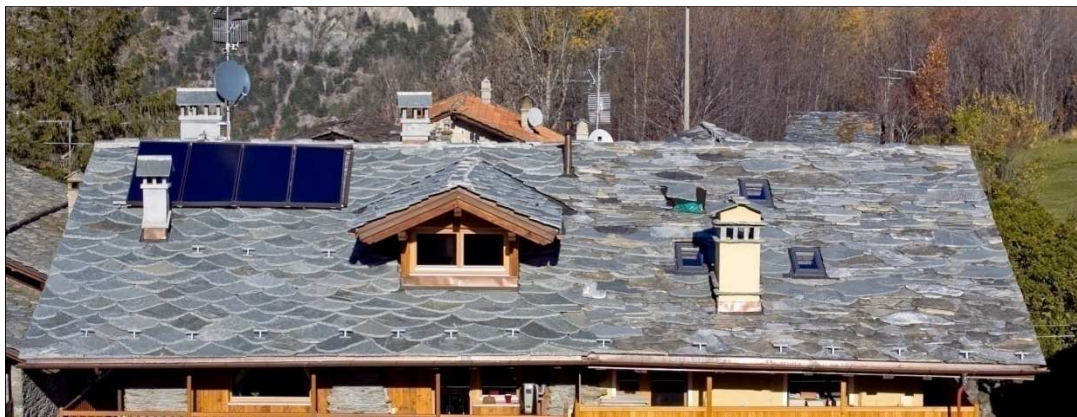
Figura 185 – Manto in lose realizzato con lose nuove e lavorazione a goccia, a destra, e a sinistra con lavorazione antica e materiale di recupero -
