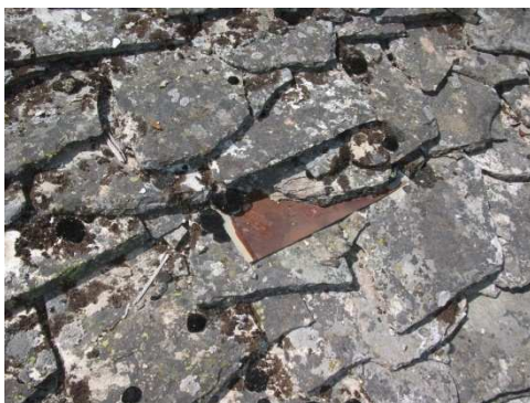
Figura 79 - Lamiera preverniciata utilizzata come otturazione –
