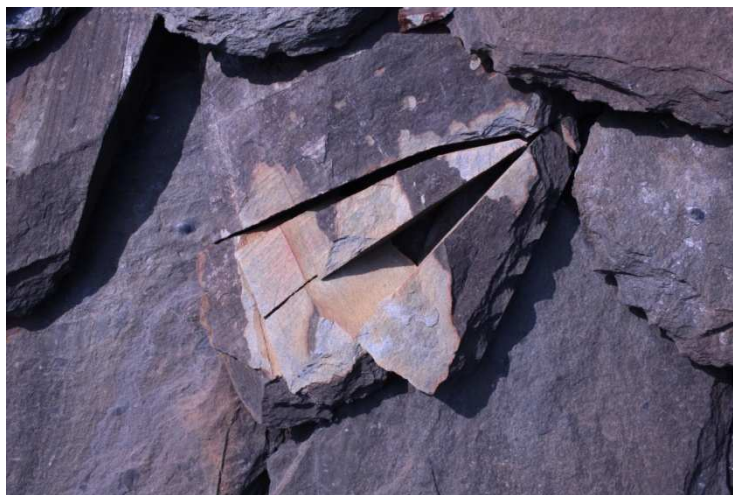
Figura 146 – Losa fratturata e fessurata –
