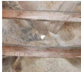
Figura 78 - Vuoto creatosi dallo scivolamento di una losa verso il basso (foto dall'interno dell'abitato) –
