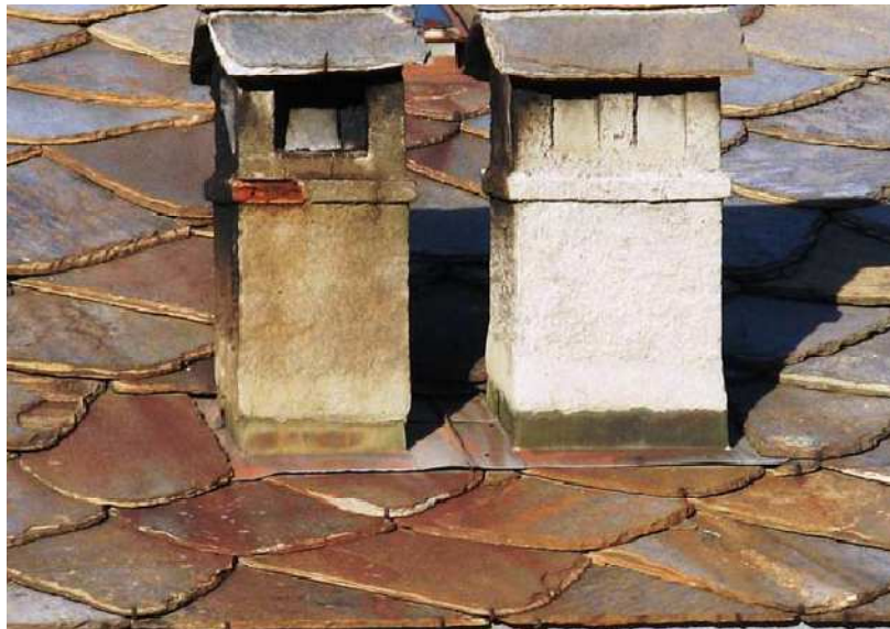
Figura 128 – Ruggine originata dalla conversa del camino e del lucernaio –
