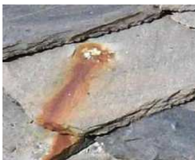
Figura 121 – Nodo della losa da cui viene originata la ruggine –
