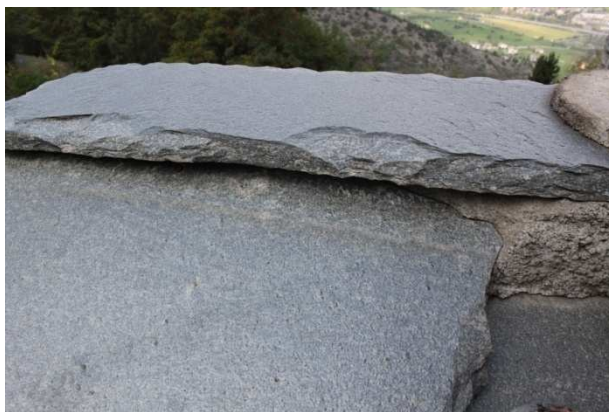
Figura 135 – Cemento assente tra il colmo e la losa a causa di un suo scivolamento fuori dalla sua sede originari –
