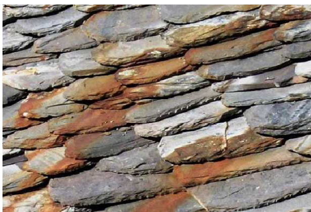
Figura 120 – Parte del tetto con evidenti colate di ruggine –
