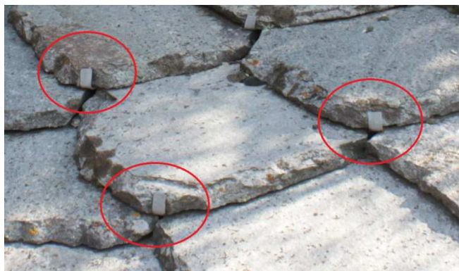
Figura 80 - Vista di alcune staffe in ferro zincato –
