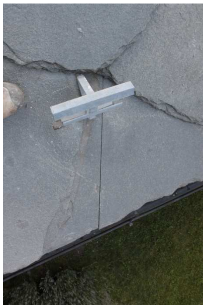
Figura 132 – Losa fratturata sul bordo inferiore della copertura –
