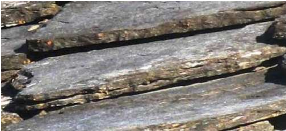
Figura 175 – Particolare di una fessurata –
