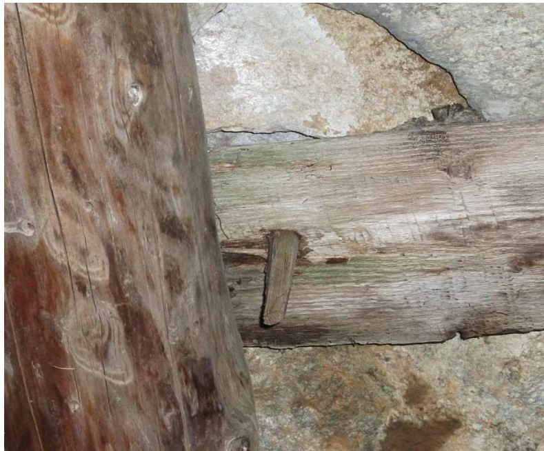
Figura 9 - Chiodo di legno per il fissaggio del listello al puntone fuori sede (foto copertura di inizio 1800 a Valsavarenche) -
