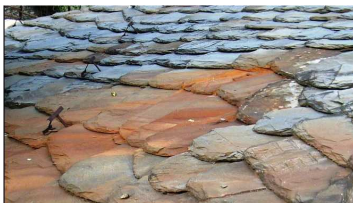
Figura 109 – Lose con importante presenza di ruggine –
