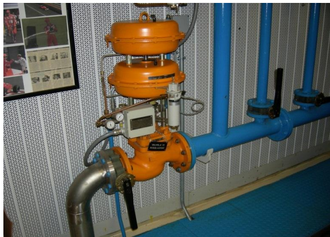
Figura 3.2 Visione della valvola principale, seguita dal ramo di by pass e dai condotti del primo e del secondo diaframma con le rispettive valvole.
