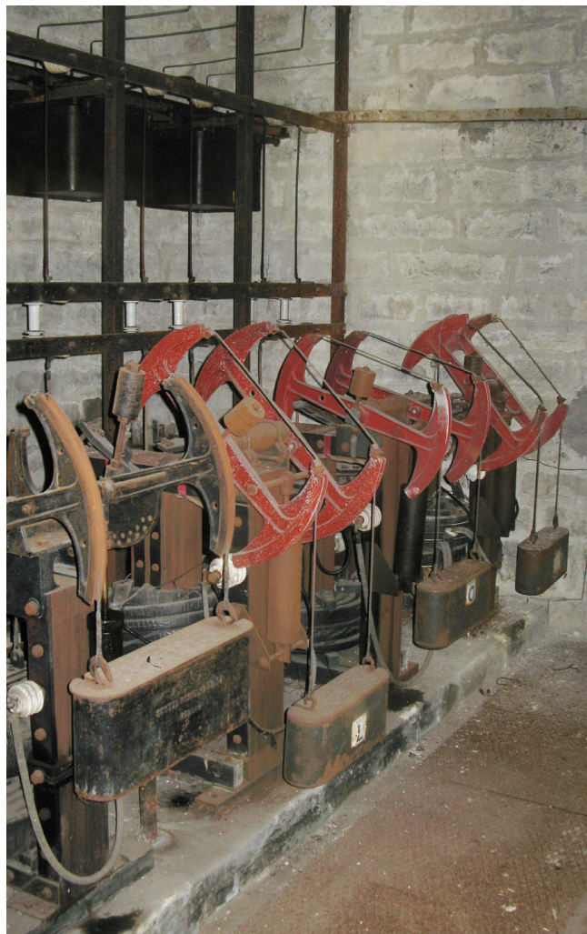
5- Parete sud-ovest. Trasformatori elettrici di Media-Bassa tensione a regolazione idraulica ora in disuso. Un tempo il locale era adibito a centralina di trasformazione elettrica e forniva corrente a tutte le utenze del centro storico (edifici, illuminazione, trasporti) 22.09.2011
