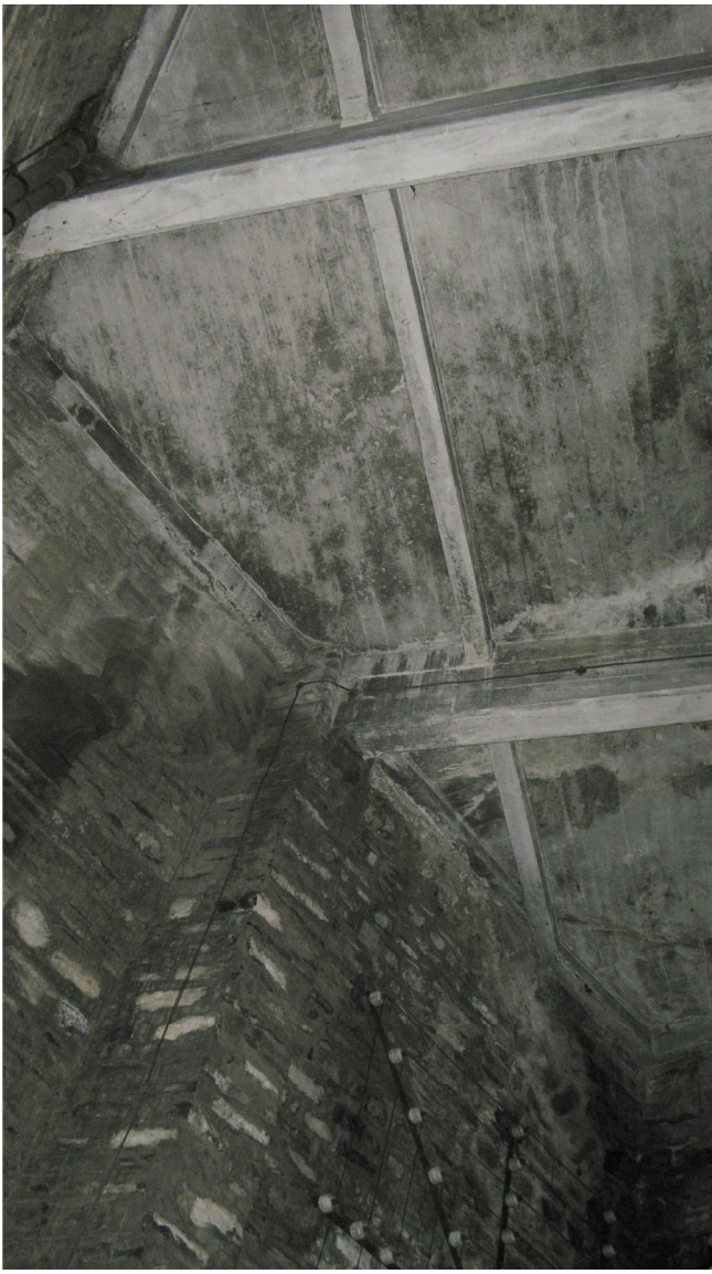
1- Prospetto interno nord contro terra, caratterizzato da forte presenza di umidità; intradosso del solaio nervato in cemento armato di partizione dei vani della Torre Gattoni con diffusa presenza di macchie e patine biologiche. 22.09.2011
