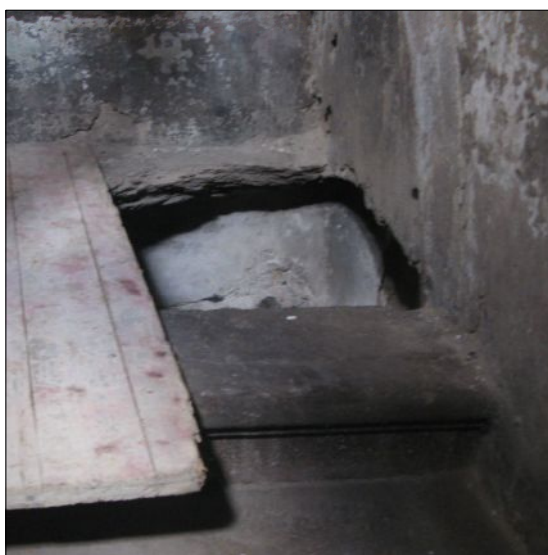
2 - Vista del buco presente all'ammezzato tra piano terra e piano primo. Da tale vano è possibile accedere agli spazi adiacenti ai piani bassi della Torre Pantera
