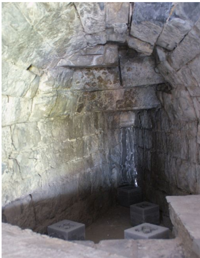
5- Apertura sotto quota pavimento nel prospetto sud-ovest; feritoia tamponata con materiale sintetico d'emergenza, collocato per evitare ingresso di volatili che nidificavano nella torre. 29.09.2011
