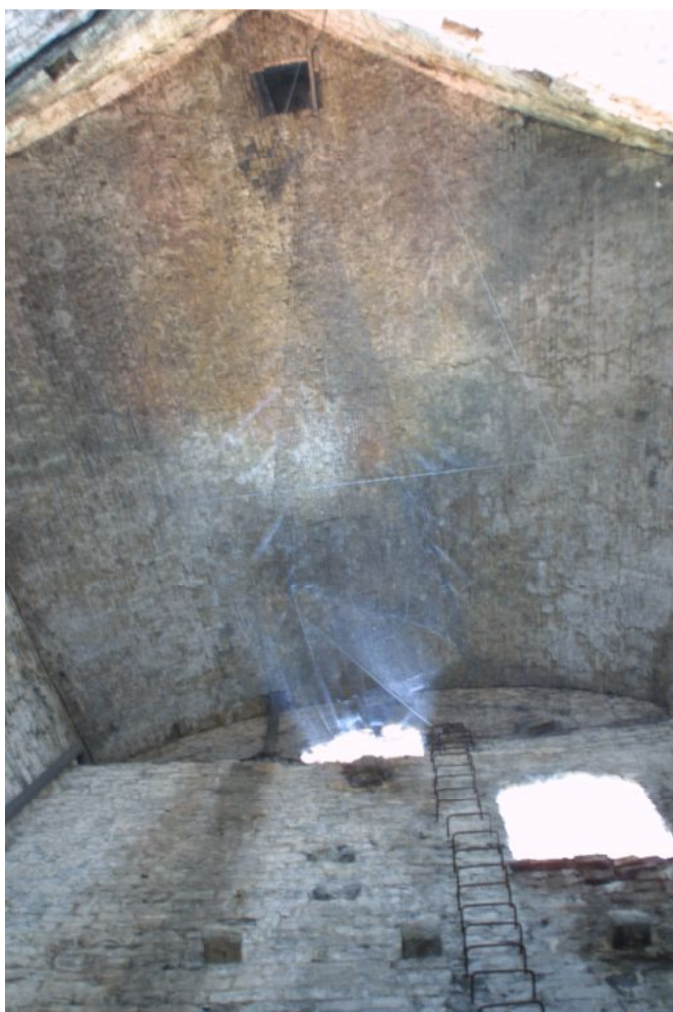
4- Intradosso copertura , volta a botte su pianta pentagonale, presenza di rete in acciaio anticaduta elementi lapidei o laterizi. 29.09.2011
