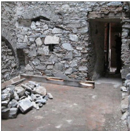
10 - Vista dell'ambiente unico della torre con pietre crollate dalla copertura accumulate in seguito al crollo del tetto del 25.10.2010
