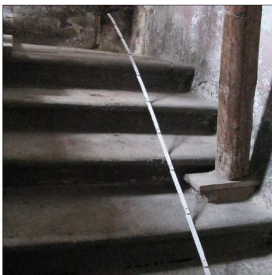
3 - Vista della rampa centrale nella quale di nota la tecnica di posa molto precaria dei puntelli di sostegno dell'intero vano scale
