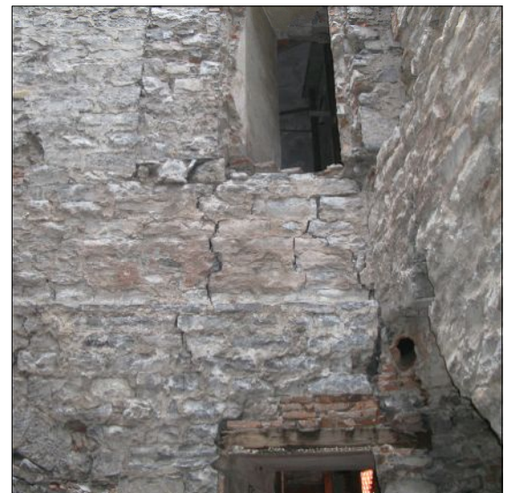
11 - Fessure verticali sopra il vano di accesso all'ambiente della torre
