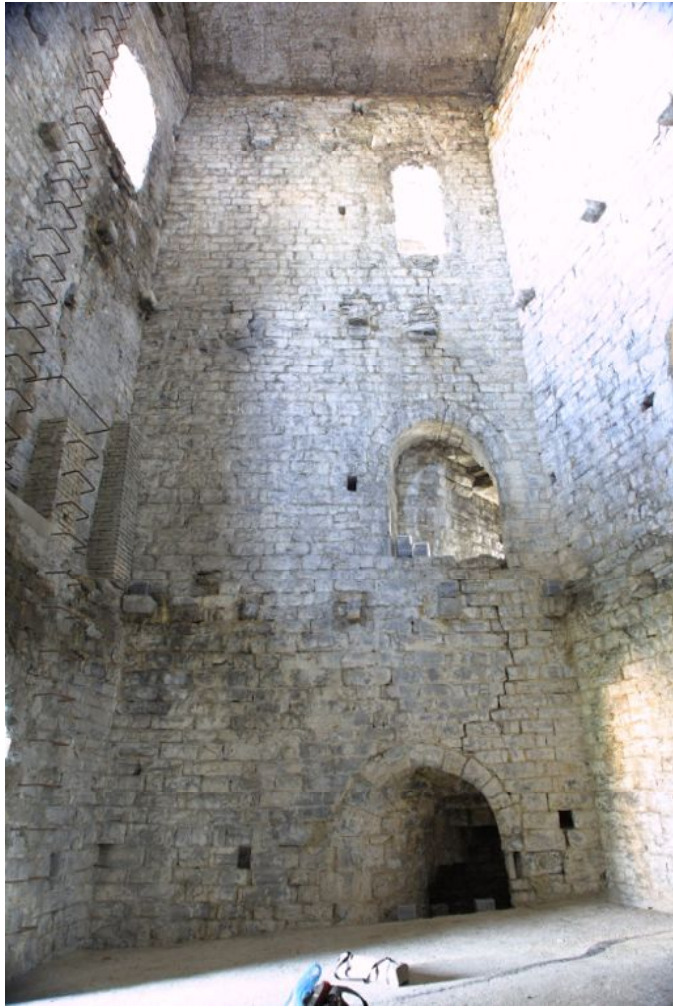
1- Parete est : fessure ad andamento verticale continuo passanti nelle aperture .29.09.2011
