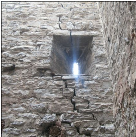
8 - ALTO - Fessure verticali sopra la nicchia in prossimità dell'angolo sud ovest, da monitorare
