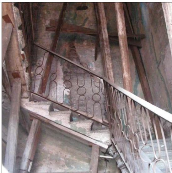
1- Vista a livello, si evidenzia a fessura all'intradosso dell'ammezzato tra piano primo e secondo
