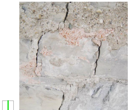
Fessure tra giunti non misurate o esili
