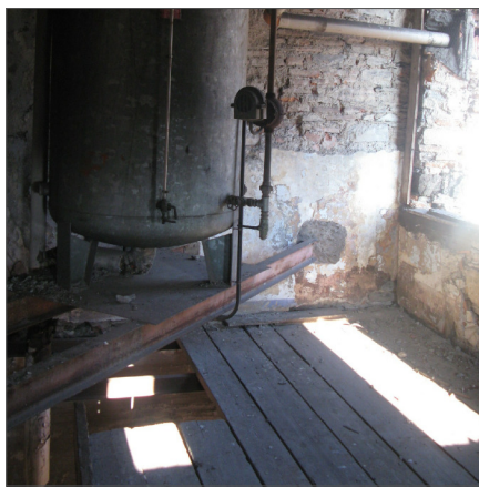
Vista del solaio dell'ambiente al piano terzo. Si evidenzia il solaio realizzato con profili IPN e assito ligneo degradato e in alcuni casi mancante; risulta mancante anche il serramento
