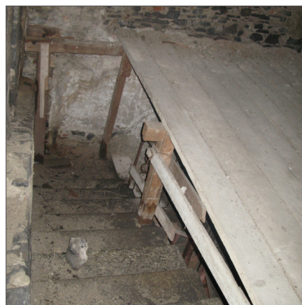
Vista del vano scala dalla soglia dell'ambiente della torre al livello terzo
