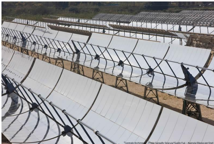
Figura 3.8: collettori solari della centrale ENEL - Priolo Gargallo. In evidenza i sostegni dell'assorbitore ogni 4 metri circa.
