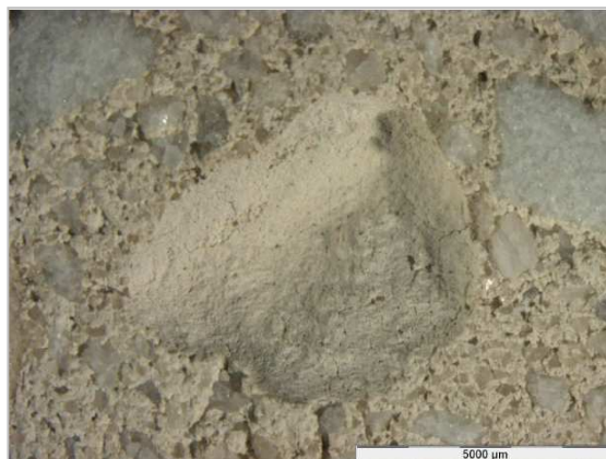
Figura 6.33 Distacco di aggregato
