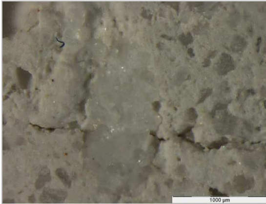
Figura 6.27 Rare fessurazioni nelle zone di separazione fra aggregato e pasta di cemento
