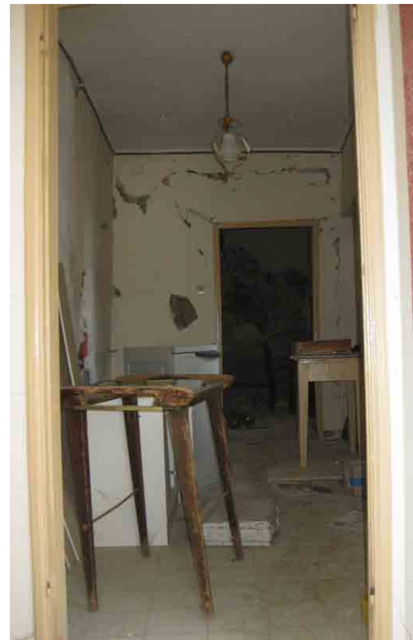
39. Vista dell'interno di una casa abbandonata, Paganica
