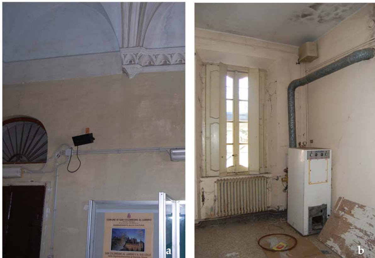
Fig. 4.8 Impianto elettrico a vista nelle stanze al secondo piano (a). Impianto di riscaldamento al primo piano con caldaia alimentata a metano e radiatori in ghisa e tubi a vista (b).
