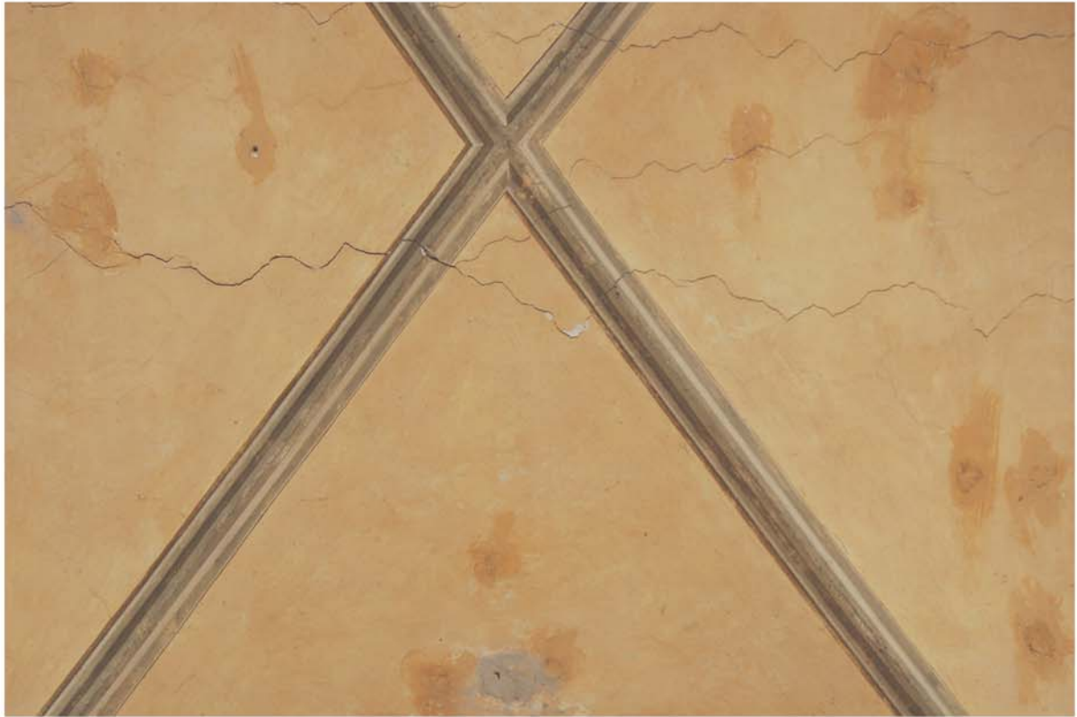
Fig. 4.1 Fessurazioni presenti nell'intradosso delle volte della galleria d'armi.
