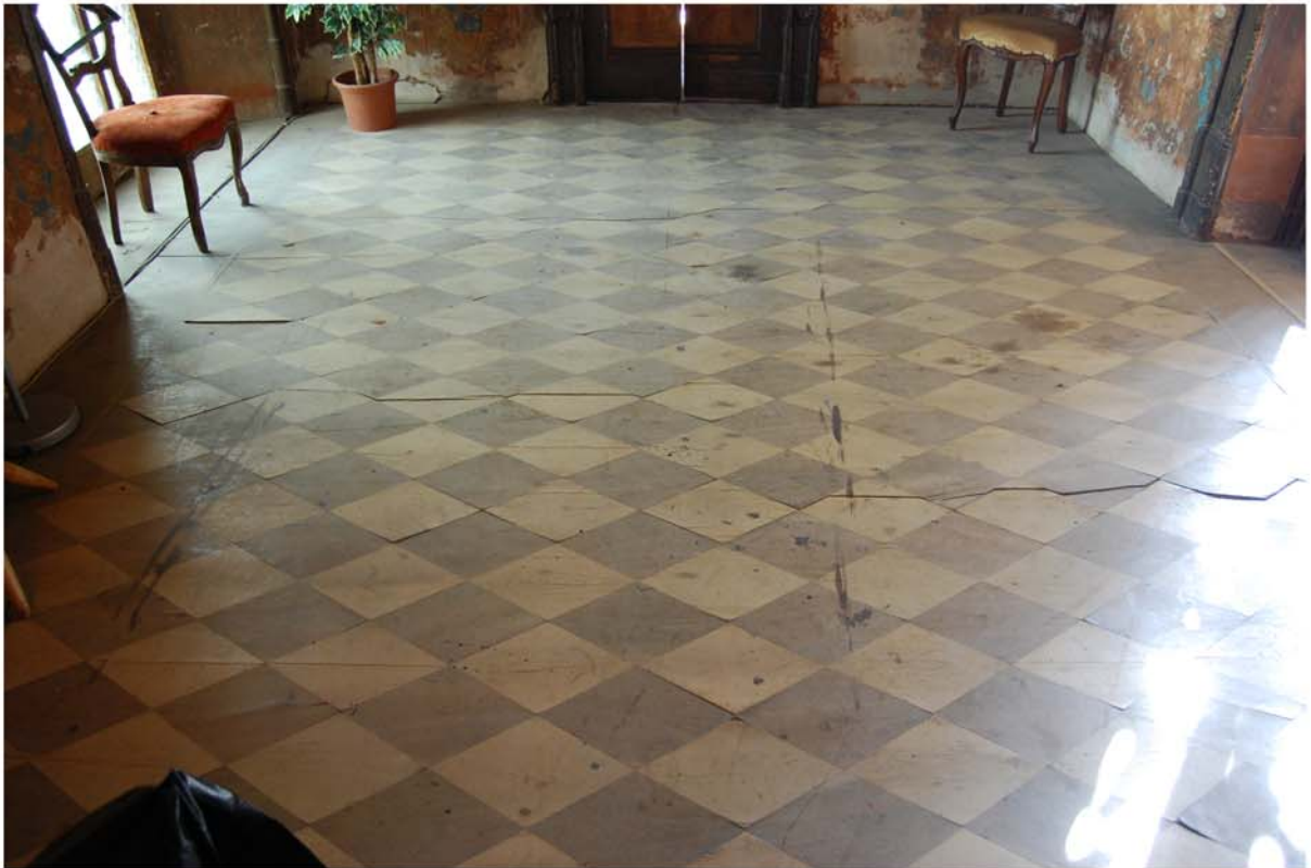
Fig. 4.6 Pavimento in legno dell'antisala con fenomeni di fessurazione, distacco e presenza di vistose macchie.
