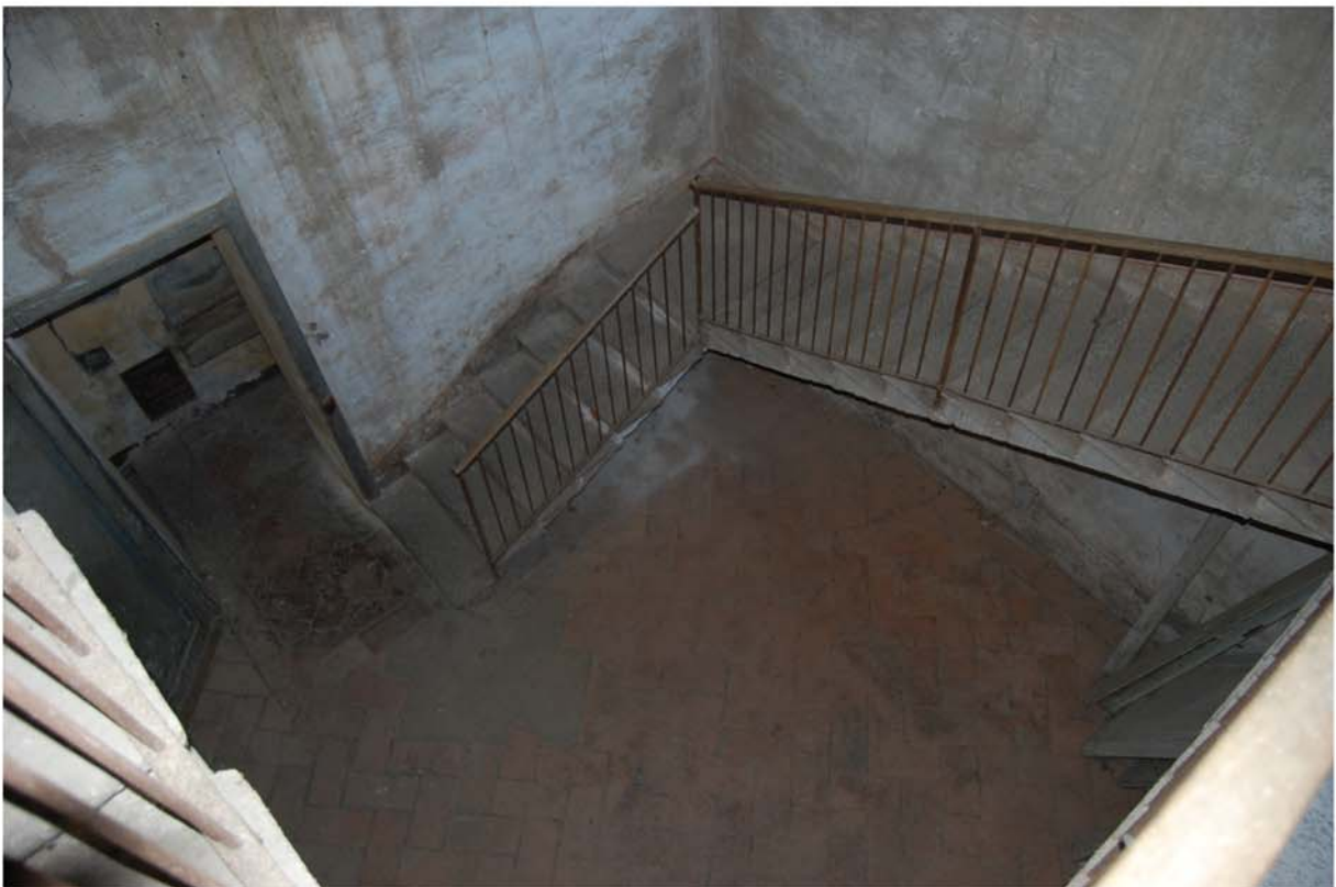
Vano scala di collegamento al terzo piano: la porta di ingresso è alla terminazione della scala principale certosina; al di sotto della pavimentazione in cotto vi è la sala con il soffitto a cassettoni dell'ex-appartamento del parroco.
