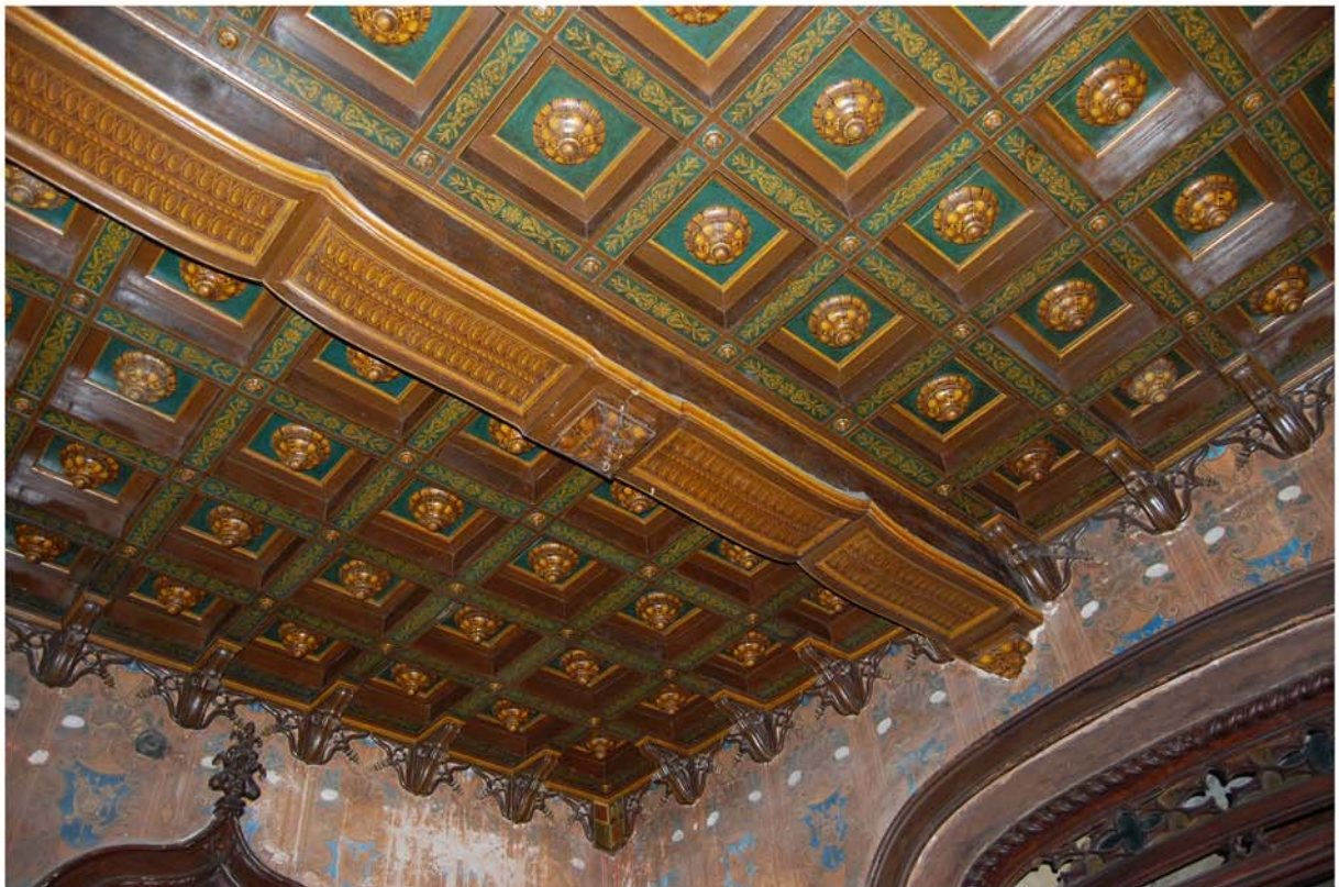
Antisala: il soffitto a cassettoni é in legno dipinto e in buone condizioni di conservazione.
