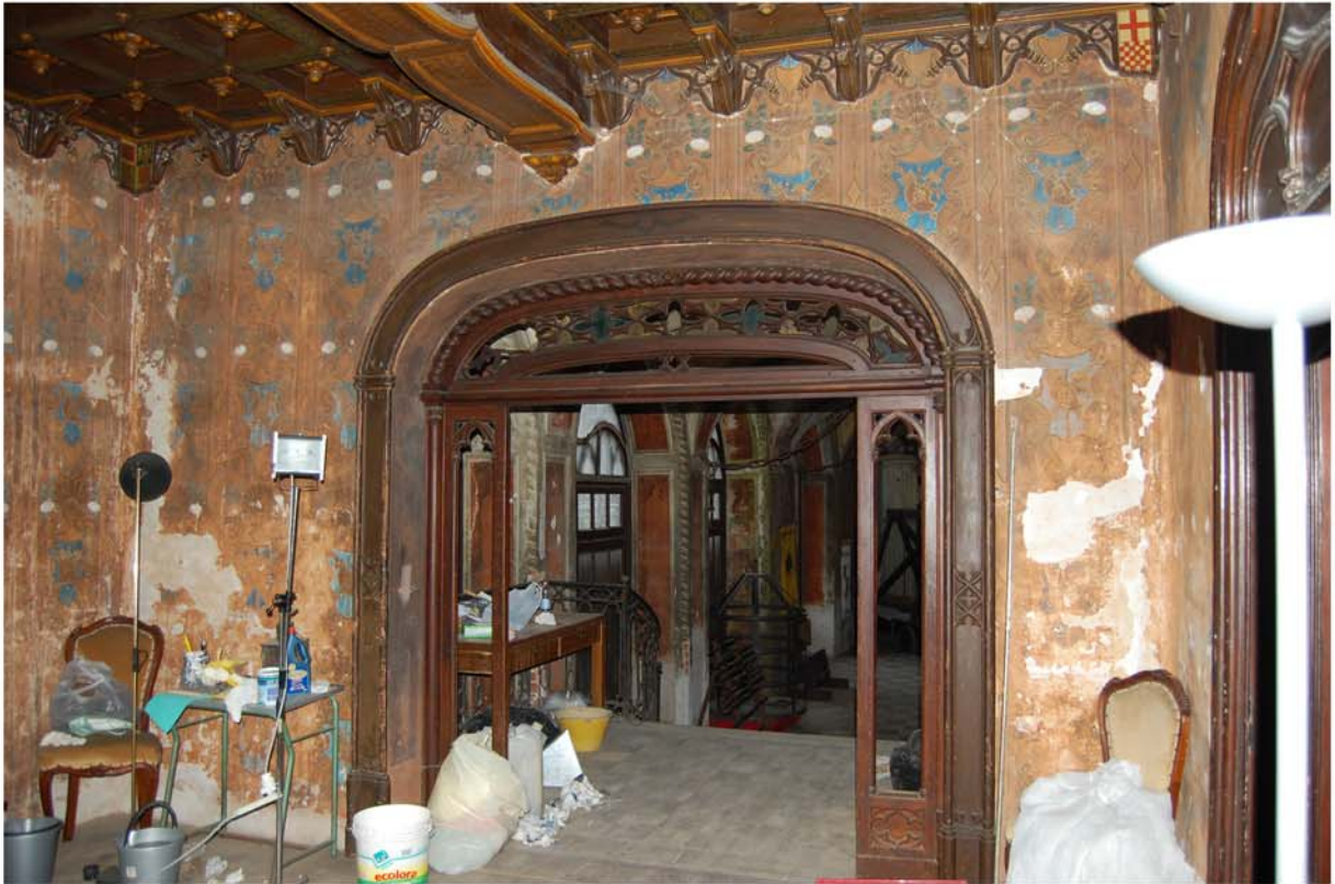
Antisala: vista in direzione della galleria d'armi; sono presenti diffuse lacune nelle decorazioni parietali a tempera.
