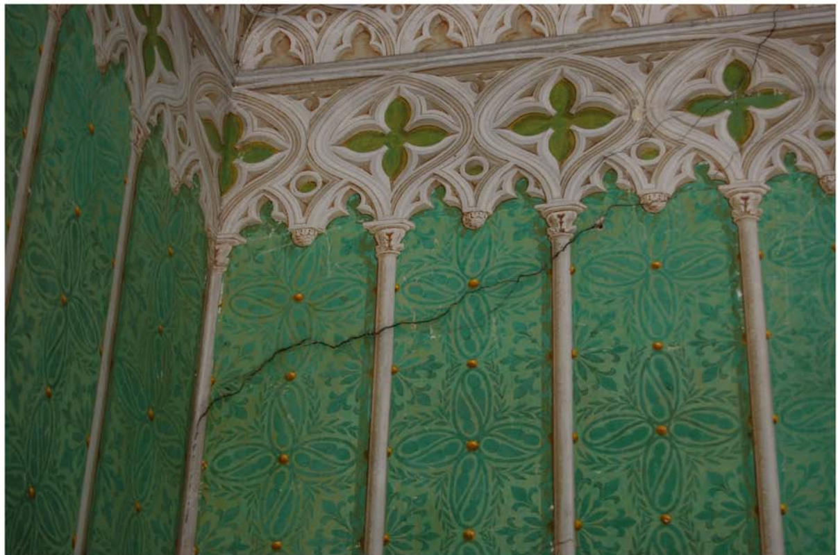
Fig. 4.2 Fessure nell'intonaco della sala Verde.
