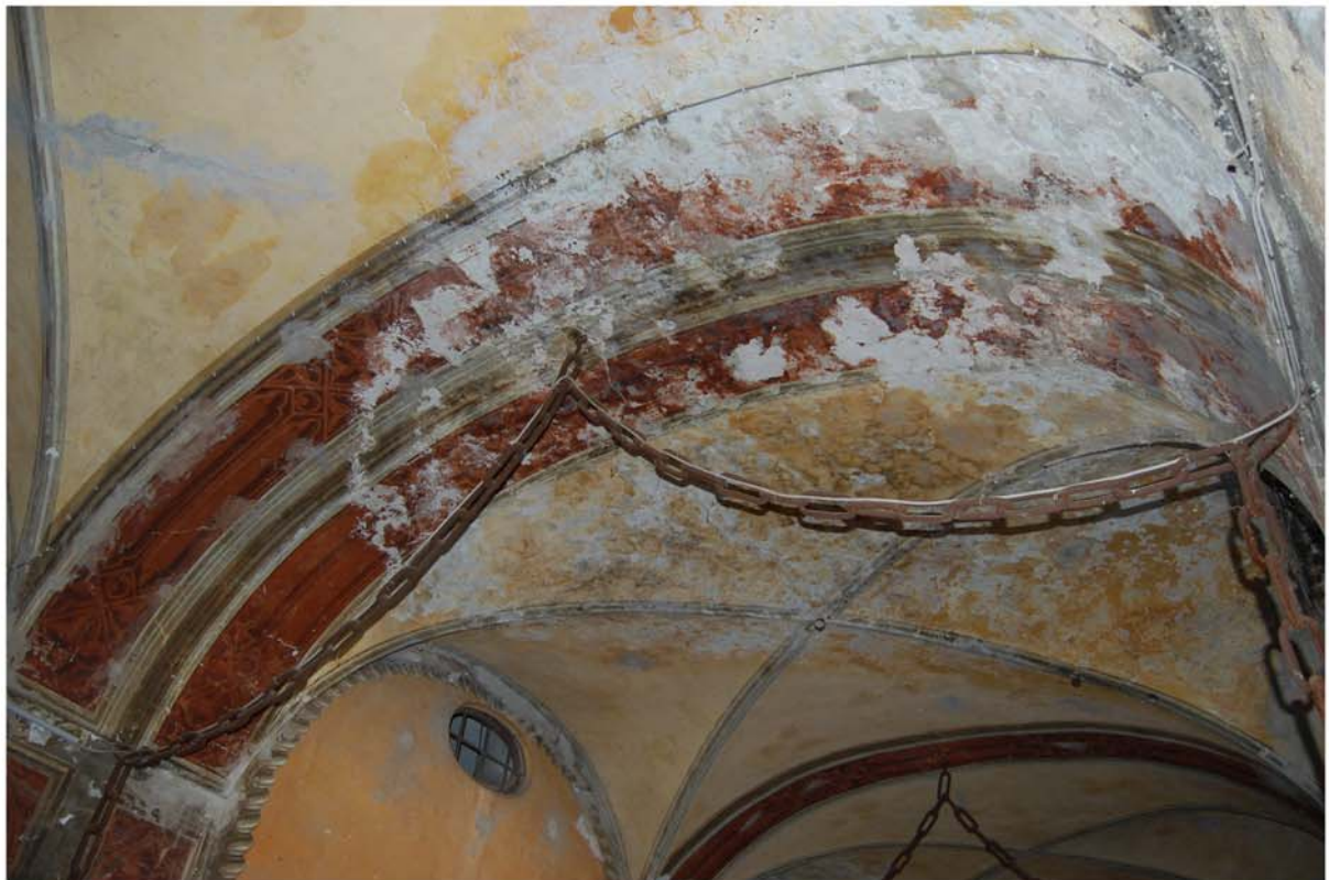
Fig. 4.4 Soffitto voltato della galleria d'armi con fenomeni di distacco, esfoliazione e macchie dovuti ad infiltrazione di acque meteoriche.
