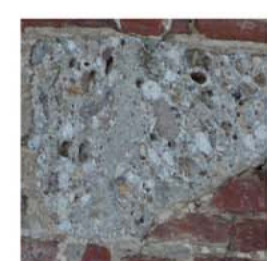
Elemento lapideo in conglomerato ad elementi poligenici denominato "Ceppo Lombardo". Zona di estrazione lungo i corsi dei fiumi Lambro e Adda nell'alta pianura lombarda. Elementi strutturali particolarmente sollecitati da parti in movimento.
