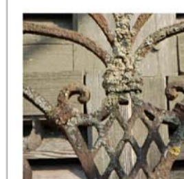
Ringhiere di balconi e scalinate in ferro battuto con ricche decorazioni. Interessate da profonda corrosione (ruggine).
