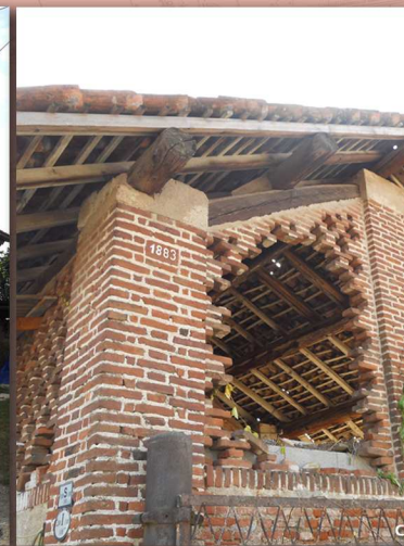
c. fenile con dissesti strutturali
