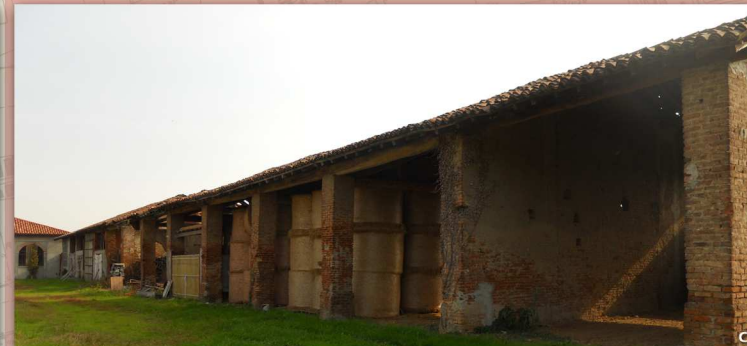
c. fienile in condizioni di degrado
