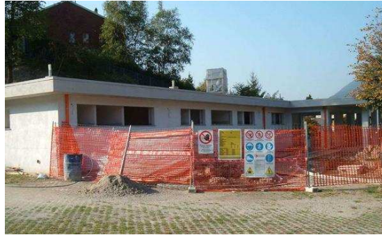
35. Centro sportivo: cantiere abbandonato
