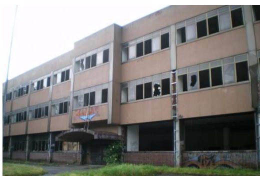
29. Degrado degli edifici del Quartiere
