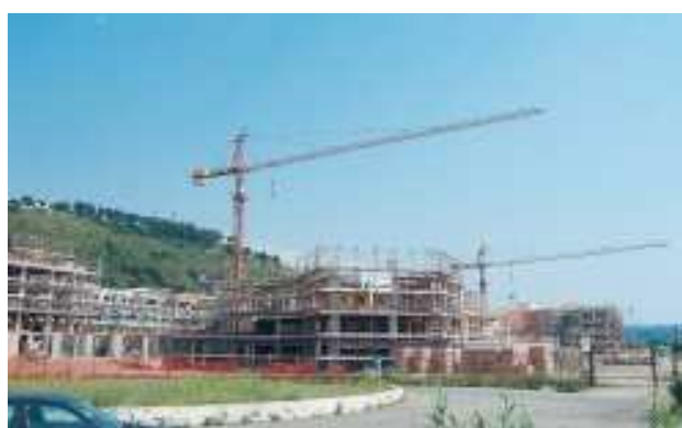
54. Cantiere abbandonato a ridosso della spiaggia
