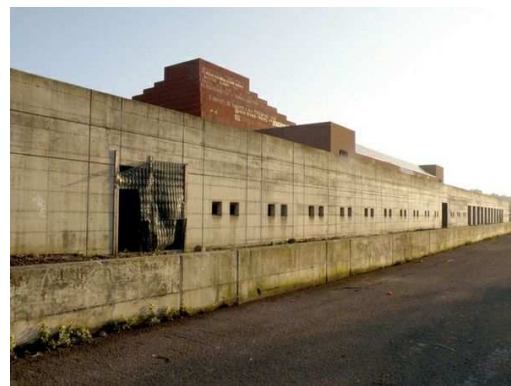
37. Evidente stato di degrado dell'intera struttura
