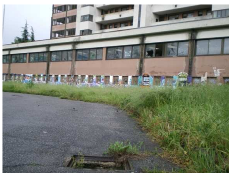
31. Degrado degli edifici del Quartiere
