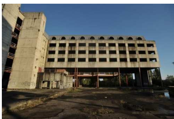
13. Degrado in cui versa l'albergo, fronte laterale
