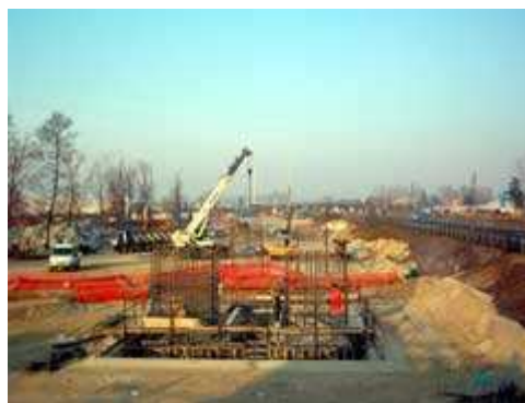
49. Cantiere aperto e abbandonato
