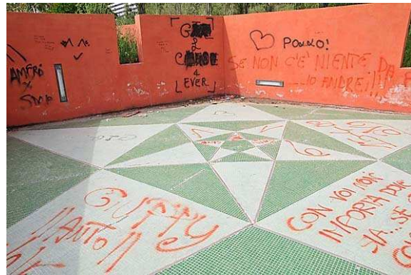
70. Incuria e abbandono delle installazioni
