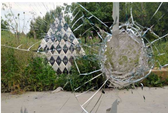
65. Degrado delle strutture
