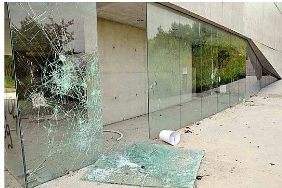
64. Situazione di forte degrado
