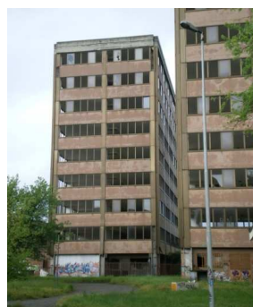
30. Degrado degli edifici del Quartiere
