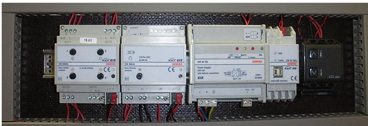
Figura 8.13: Dispositivi Gewiss impiegati nella realizzazione del pannello, da sinistra verso destra: attuatore 4 canali (GW90836), dimmer (GW90844), alimentatore bus KNX (GW90702), interfaccia usb (GW90706A), attuatore tapparella (GW12767)
