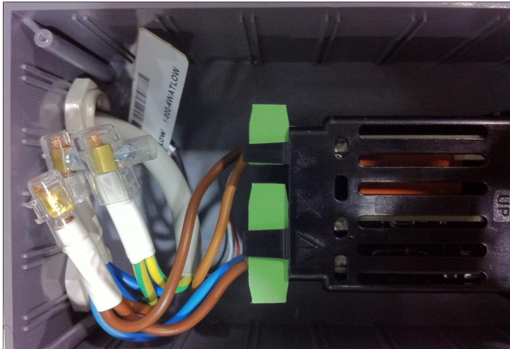
Figura 30: Cablaggio del termoregolatore
