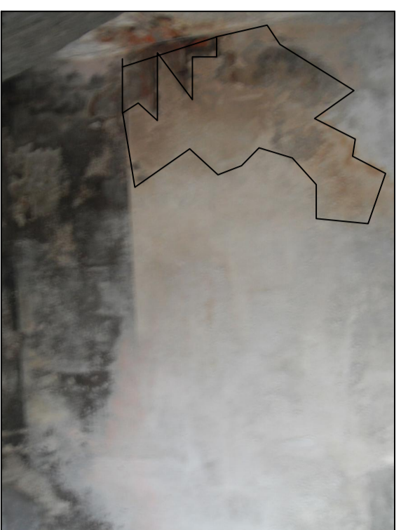
Dettaglio del degrado della parete
