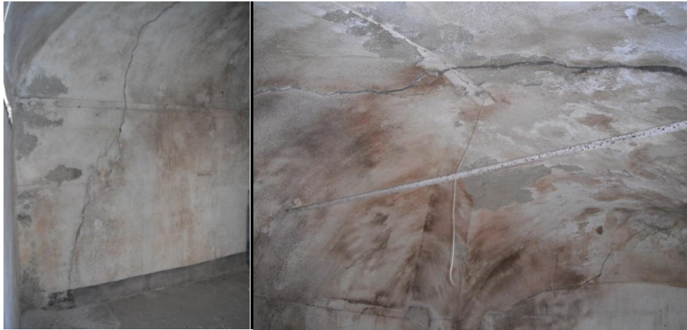
Fig. 120 – 121 Il degrado della bottega, lesione della parete e dettaglio del proseguimento della lesione sulla volta.
