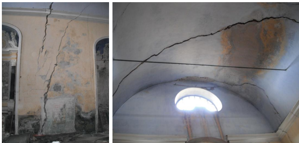
Fig. 95 - 96 Frattura della parete e del soffitto dietro all'altare di Sant' Andrea
