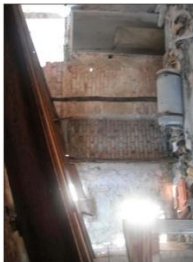
Dettaglio dello stato di degrado della parete che confina con la stanza murata.
