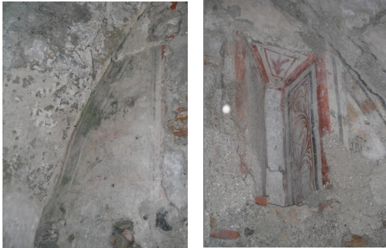
Fig. 114 – 115 Chiesa di San Mauro, tracce di affreschi sulla parete interna. (Foto scattata ad agosto 2011).
