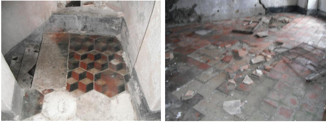
Fig. 77 – 78 Pavimento del pianerottolo del primo piano (si notano ancora le tonalità luminose) e sala da pranzo con dettaglio del cedimento del pavimento.
