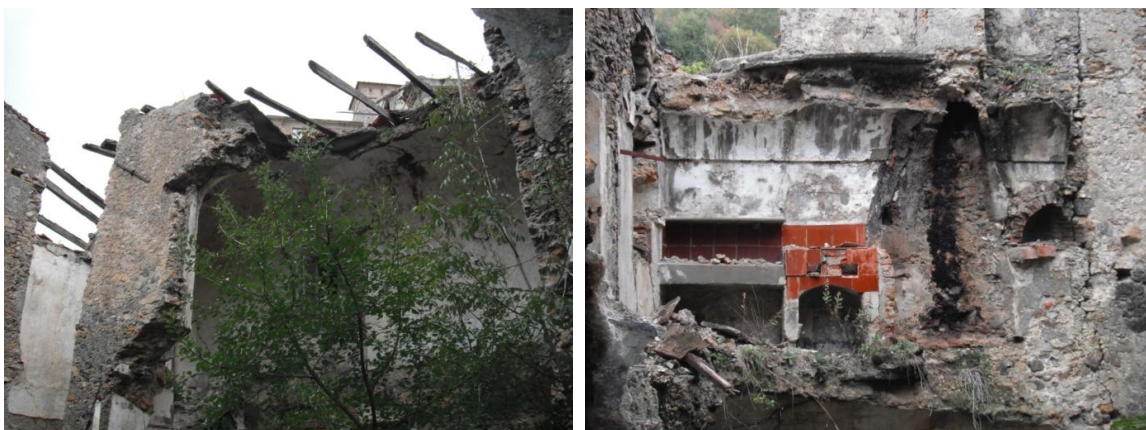
Fig. 15 – 16 Edifici crollati lungo via Matteotti, nel lato che si affaccia verso valle; a destra e' ben visibile il forno di una cucina.
