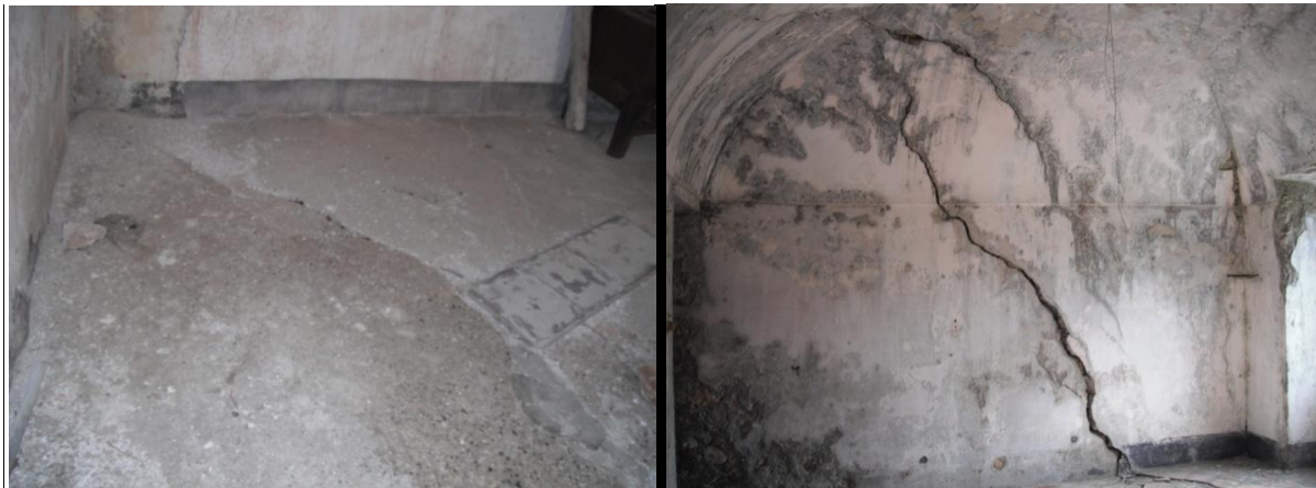
Fig. 122 – 123 La lesione sul pavimento della bottega, a destra la parete della sala da pranzo, qui si può notare una frattura che parte dal soffitto, attraversa tutta la parte e prosegue poi sul pavimento, tagliando per così dire la stanza in due parti.
