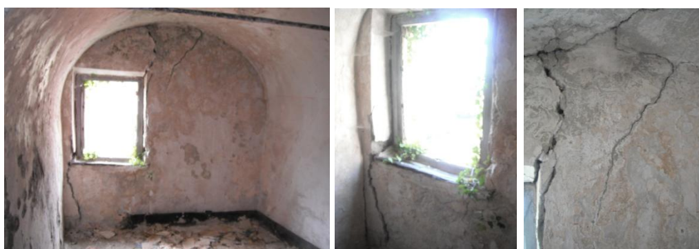
Parete con vista su valle, nelle foto al centro e a destra dettagli delle due lesioni agli angoli dell'infisso nella parte inferiore sinistra e superiore destra.
