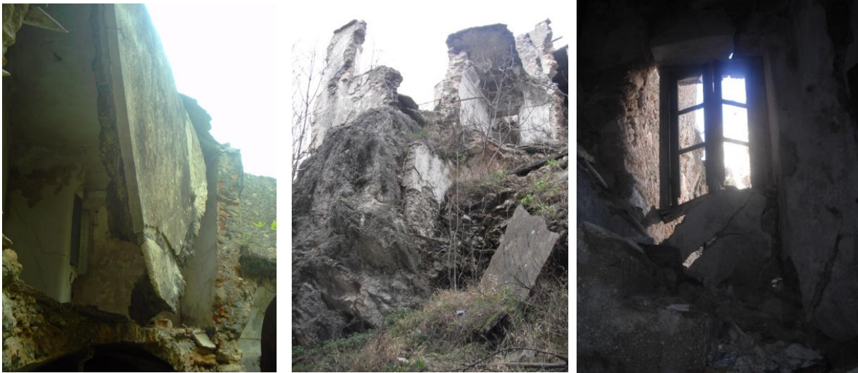
Fig. 11 - 12 - 13 Edificio situato dietro Casa Panizza; dettaglio della zona crollata ai piedi del castello.
