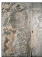
Dettaglio del degrado del soffitto della cucina
