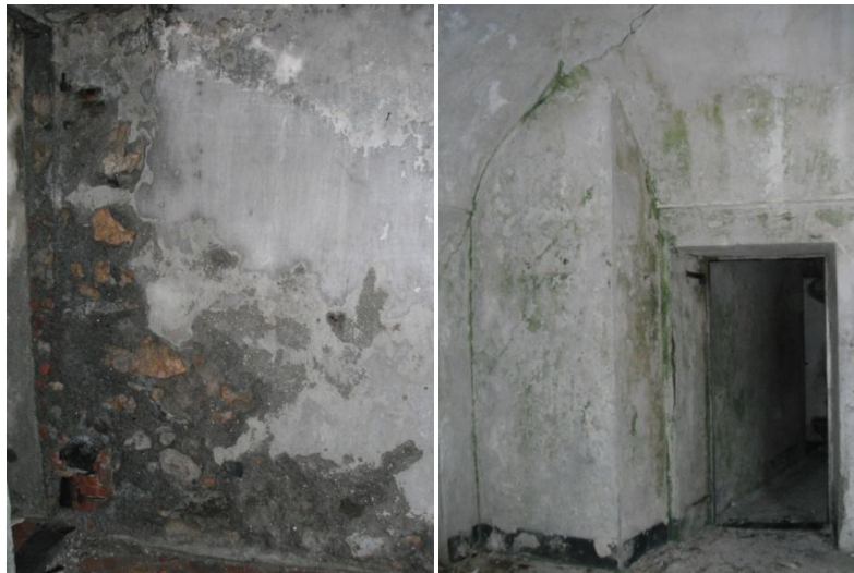
Fig. 100 – 101 Degrado delle superfici murarie provocato da umidità di risalita che ha causato efflorescenze e distacco dell'intonaco, a sinistra; umidità di condensazione con formazione di muffa, a destra.
