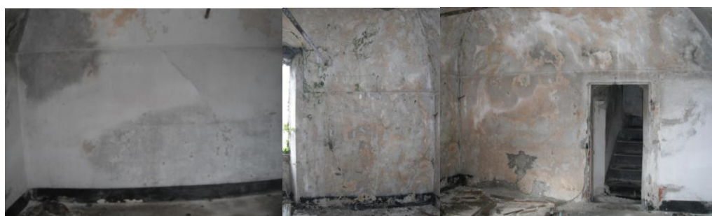
Dettagli del degrado delle pareti interna e con affaccio su piazza.
