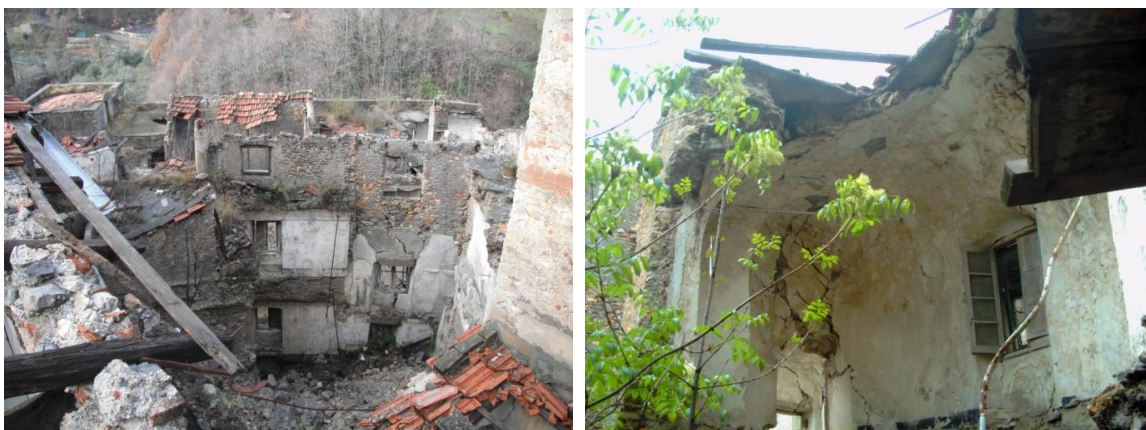
Fig. 17 – 18 Dettagli della parte crollata del Borgo, dietro via Matteotti.
