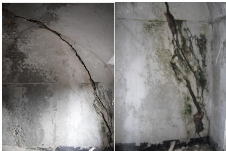
Fig. 124 – 125 Fessurazione della parete di una stanza al piano terra di casa Panizza con dettaglio.
