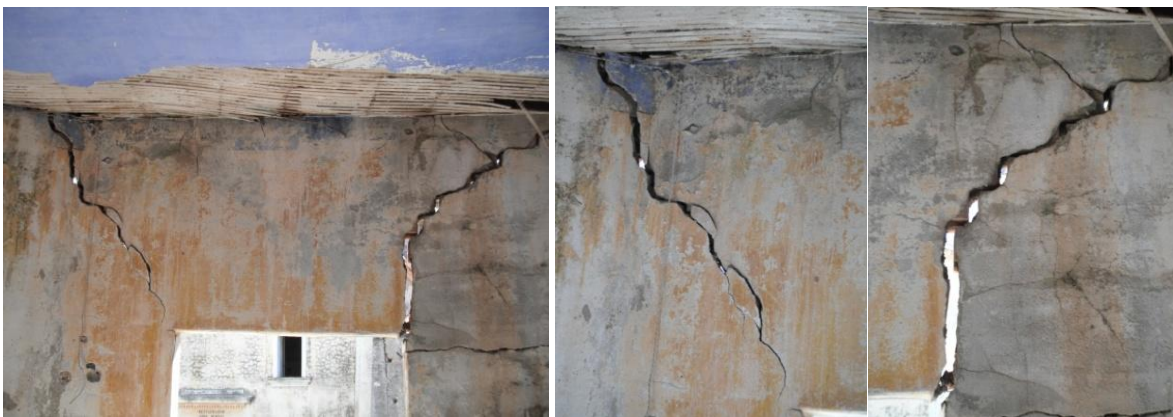
Fig. 117 – 118 – 119 Dettagli della fessurazione della parete, con affaccio su piazza della stanza dipinta, fessurazioni verticali passante dovuta ad assestamenti strutturali.
