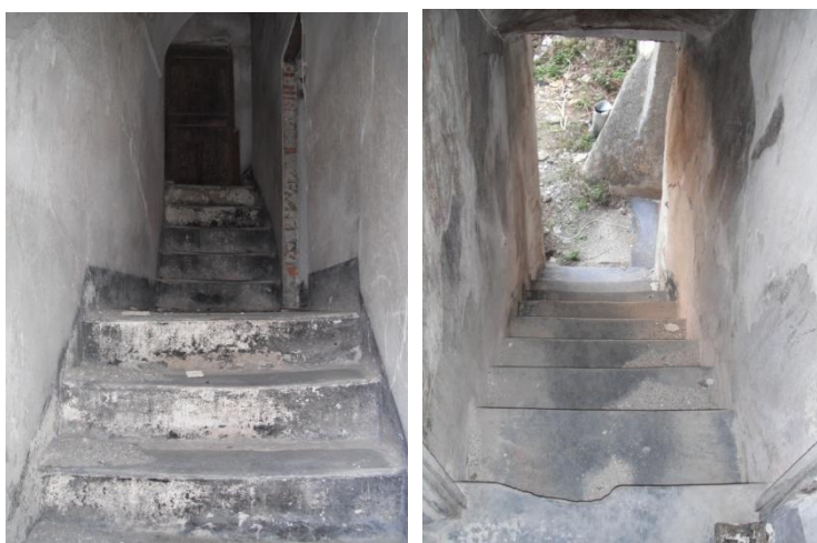
Fig. 29 - 30 A sinistra, uno dei due accessi della casa dalla piazza; a destra, scala che si trova accanto alle cantine.
