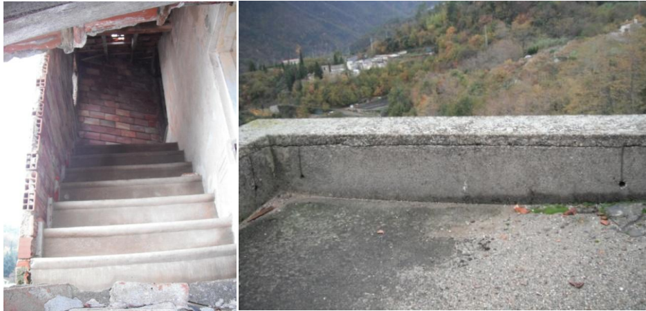
Fig. 52 – 53 Scala accesso al sottotetto e terrazzino con dettaglio dei buchi in cui era agganciato il parapetto in legno.
