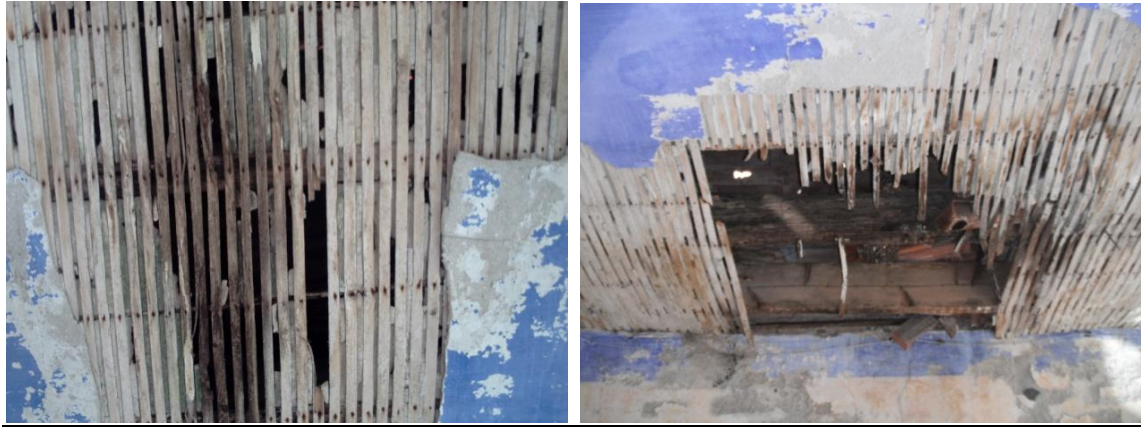
Fig. 68 – 69 Dettagli del degrado del soffitto dipinto.
