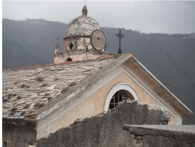
Fig. 97 Foto del tetto della chiesa di Sant' Andrea e del campanile ricoperto di lastre di ardesia.
