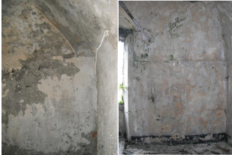
Fig. 98 – 99 Degrado delle superfici murarie provocato da umidità e infiltrazioni di acqua, manifestato con macchie superficiali, erosione, distacchi ed efflorescenze.
