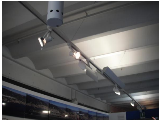
Fig. 37 Esempio di impianto elettrico moderno all'interno del museo navale di Genova.
