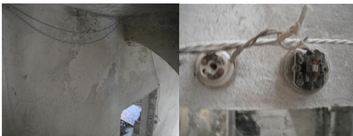
Fig. 33 – 34 Tracce dell'impianto elettrico sul muro esterno della cucina del primo piano di casa Panizza e vecchi interruttori.
