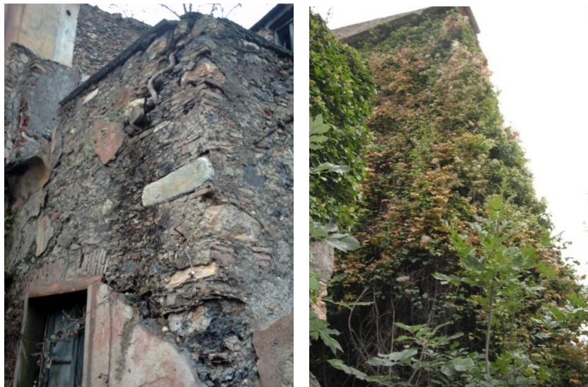
Fig. 96 – 97 Due esempi di piante infestanti, a sinistra l'edificio accanto alla casa del Marchese e a destra l'affaccio di casa Panizza su via Sottoriva.
