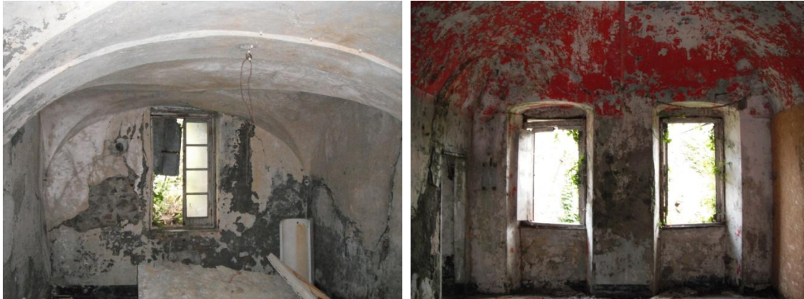
Fig. 43 - 44 Locale al piano terra con tracce di impianto elettrico. Sul pavimento resti del set del film Inkheart. A destra parete del salone con soffitto tuttora dipinto di rosso.
