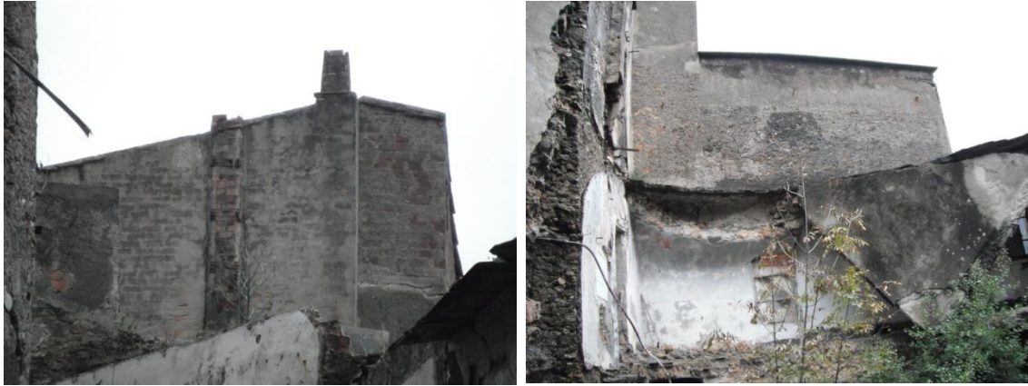
Fig. 115 – 116 Casa Panizza vista dall'edificio laterale crollato
