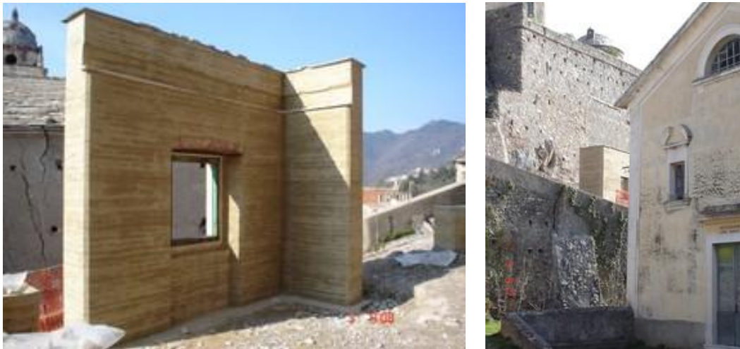
Fig. 8 - 9 Manufatto testimone costruito con la tecnica del pisè (terra cruda) e Inserimento del manufatto in pisè all'interno del contesto del Borgo.
