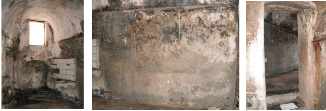
Degrado delle pareti della cucina del piano rialzato, nell'immagine a destra accesso alla cucina dall'ingresso dell'edificio.
