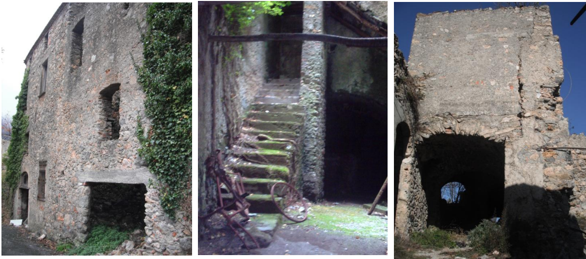
Fig. 8 - 9 - 10 Casa situata all'inizio di via dei Marchesi del Carretto; dettaglio dell'ingresso di un'abitazione in zona di porta Fasciora ed un'edificio situato ai piedi del Castello, dietro Via Marchesi del Carretto, al di sopra degli edifici crollati (fig.6).
