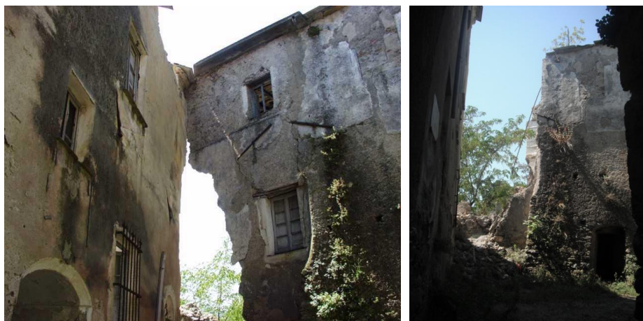
Fig. 57 - 58 Dettaglio di un edificio degradato con affaccio su Piazza Inferiore (agosto 2010) e Foto che attesta il crollo di parte dell'edificio della foto precedente (agosto 2011).
