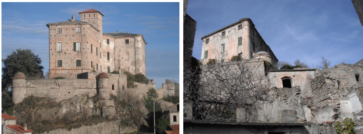
Fig. 11 - 12 Il castello dei Del Carretto visto dal nuovo nucleo di Balestrino e affaccio sulla parte crollata del Borgo.
