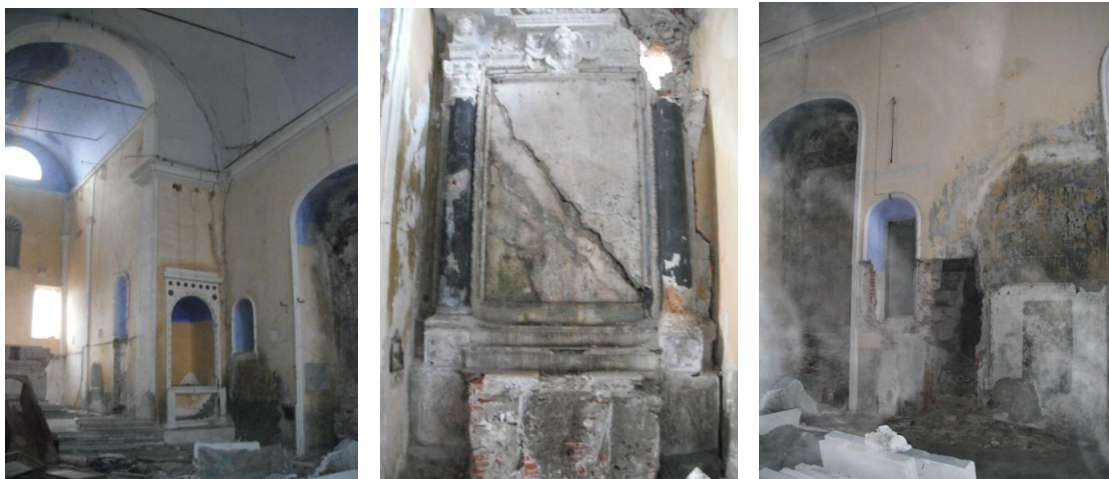
Fig. 92 - 93 - 94 Interno di Sant' Andrea, dettaglio di un altare e degrado della parete.
