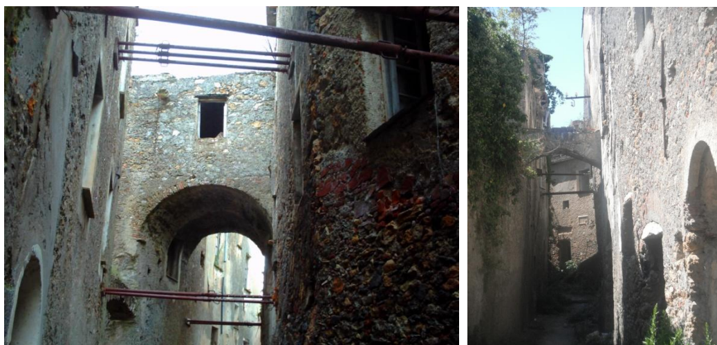
Fig. 131 – 132 Arco di contrasto edificato all'interno del borgo di Balestrino; a destra, arco di contrasto semplice.
