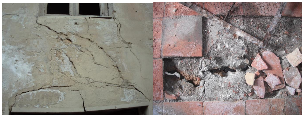
Fig. 126 – 127 Dettaglio delle lesioni presenti in facciata, sopra al portone da cui si accede alle cantine; a destra, dettaglio della lesione della pavimentazione della sala da pranzo situata al piano rialzato.
