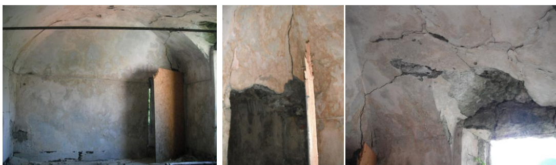
Parete con falsa porta divisoria in legno, a destra dettaglio del degrado della muratura sopra la finestra.
