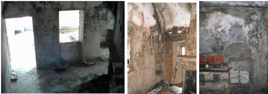
Parete divisoria della cucina dalla sala da pranzo (foto scattata dalla scala esterna dell'edificio); al centro dettaglio dell'accesso alla stanza con la dispensa; a destra, dettaglio del degrado della muratura vicino ai fornelli.
