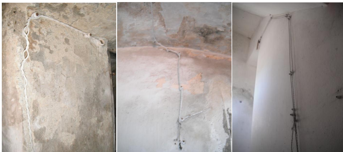
Fig. 35 – 36 Impianto elettrico presente in due stanze di casa Panizza e nel sottoscala davanti all'ingresso della cucina del primo piano.
