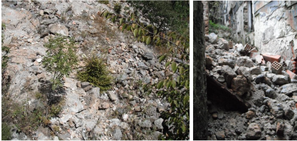
Fig. 15 – 16 Detriti della parte crollata del borgo di Balestrino e crollo di un edificio avvenuto nel mese di Novembre 2010.
