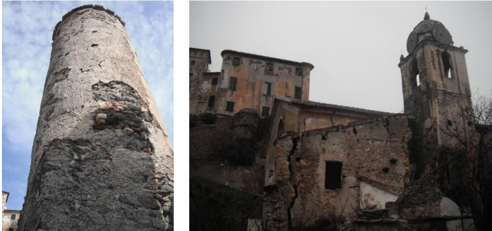
Fig. 86 - 87 Il Pilone e dettaglio del degrado della canonica.
