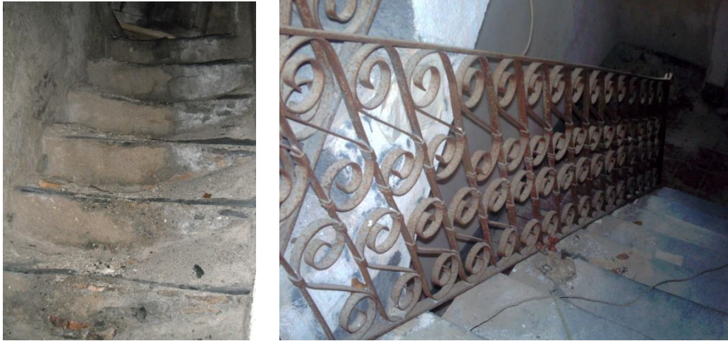
Fig. 133 - 134 Scala interna di Casa Panizza, appoggiata alla muratura e a doppia rampa, della tipologia diffusa a Balestrino e dettaglio della ringhiera di una casa del borgo.
