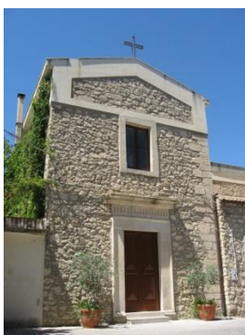
Fig. 24 - Caltabellotta, irrigidimento di una muratura tramite cordolo in C.A. Il sistema concentra un carico notevole in copertura, creando una netta differenza di rigidità tra le due porzioni dell'edificio.
